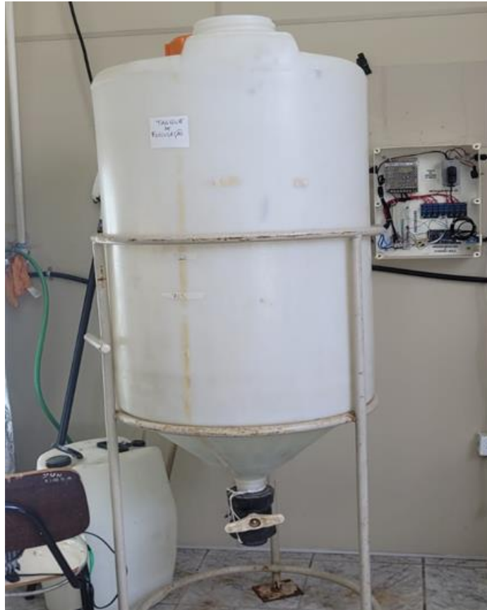
Figura 7 – Tanque de Floculação
