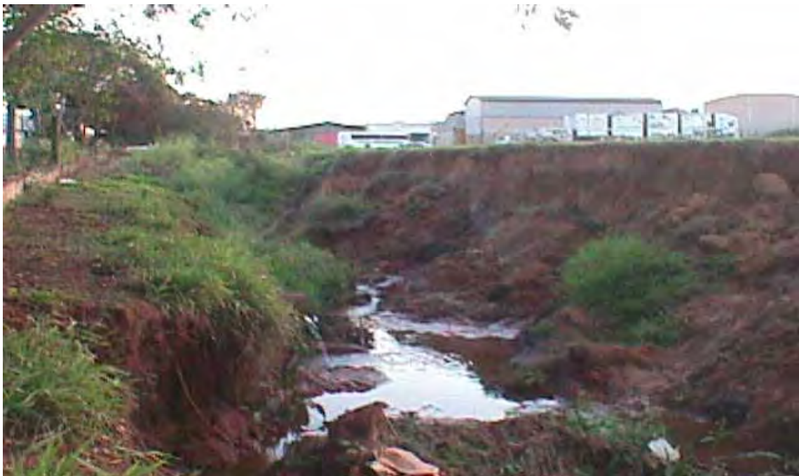
Foto 6: Sinais de retomada erosiva transversal e longitudinal, a montante da canalização do Ribeirão Tijucu Preto. Autor: (Silveira, 2007).
