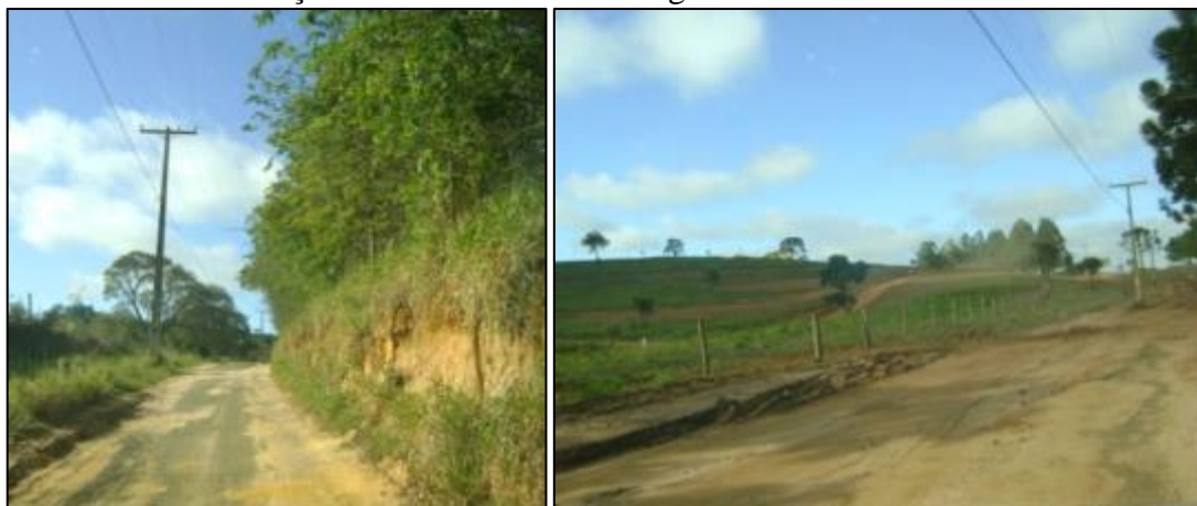
Figuras 42 e 43. Situação alarmante das estradas rurais, sem drenagem das águas pluviais e formação de taludes altos às margens das estradas rurais.
