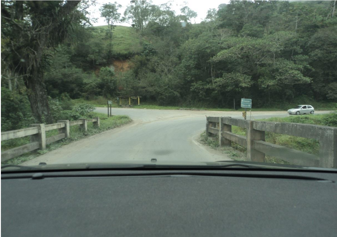
Imagem 7 Ponte que trafega um veículo por vez situada entre duas grandes curvas: ausência de visibilidade – fonte: Felipe Queiroz Miano
