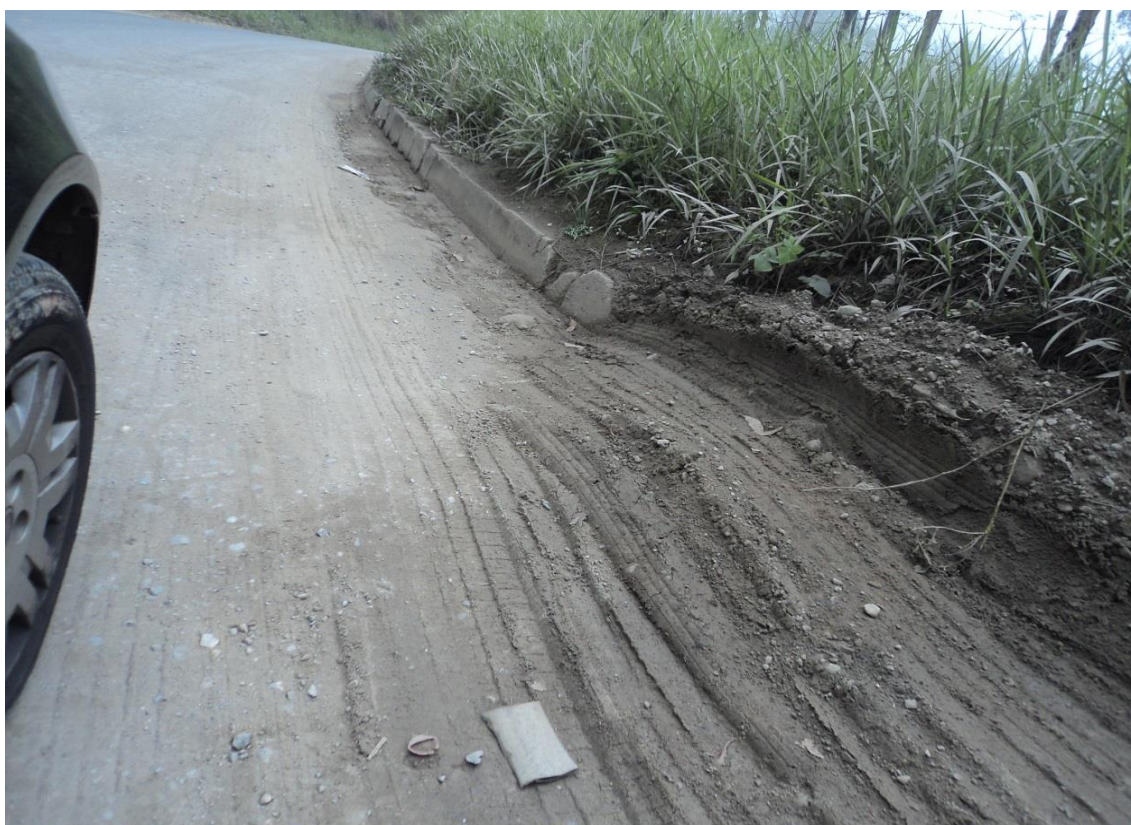
Imagem 6 Ausência de Recapeamento de asfalto na rodovia – fonte: Sérgio Queiroz Gonçalves Neto
