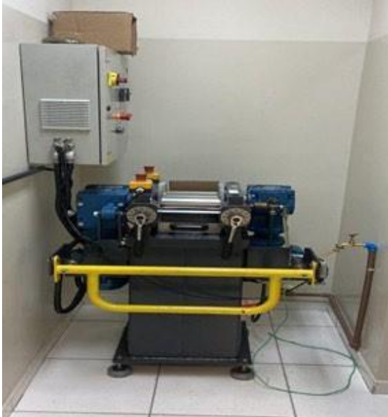
Figura 37 - Misturador aberto de cilindros
