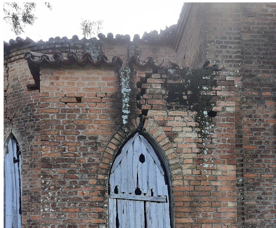
Figura 25 : Trincas na fachada da Capela. Fonte: Acervo pessoal da autora, 2024.
