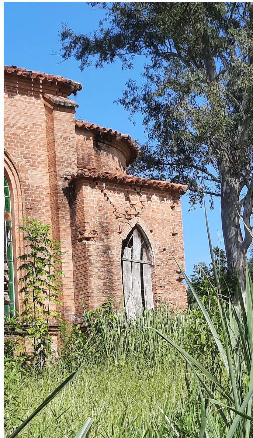
Figura 26: Trinca na fachada da Capela. Fonte: Acervo pessoal da autora, 2024.
