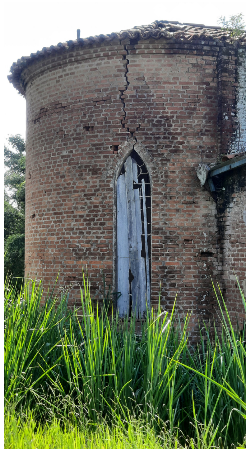
Figura 27: Trinca na fachada da Capela. Fonte: Acervo pessoal da autora, 2024.
