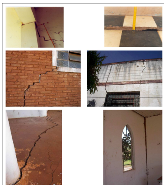
Figura 2 – Danos em edificações provocados pelo colapso do solo
