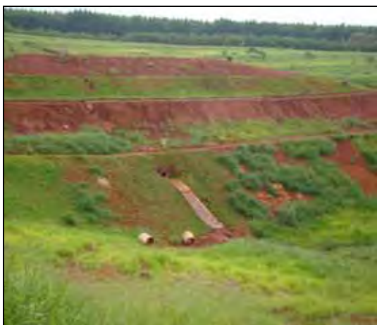
Foto 24 - Canaleta para chorume e tubos para passagem de água pluvial. Fonte: Cantóia, 2009.
