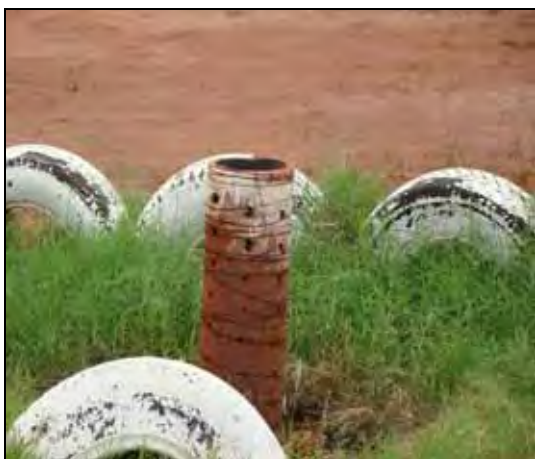
Foto 84 - Queimador de gás metano Fonte: Cantóia, 2009.
