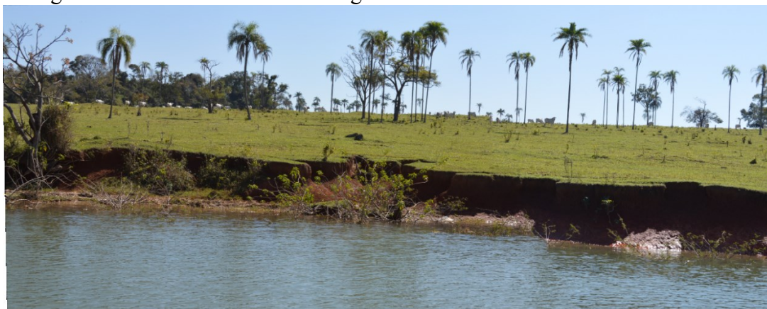
Figura 40: Processo erosivo às margens do reservatório da UHE de Chavantes.
