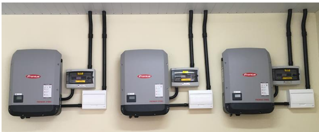
Figura 11: Vista dos inversores da entidade.
