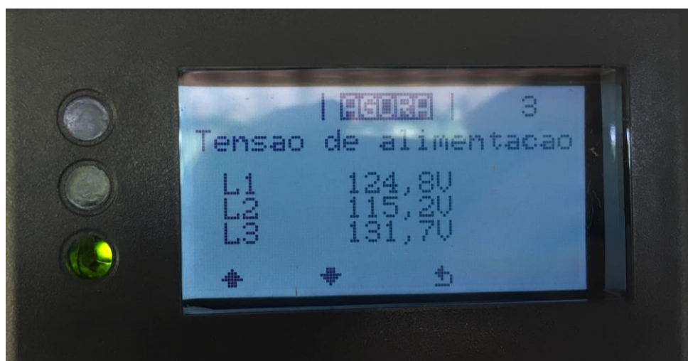
Figura 19: Tensão de fase no inversor 3 da entidade.
