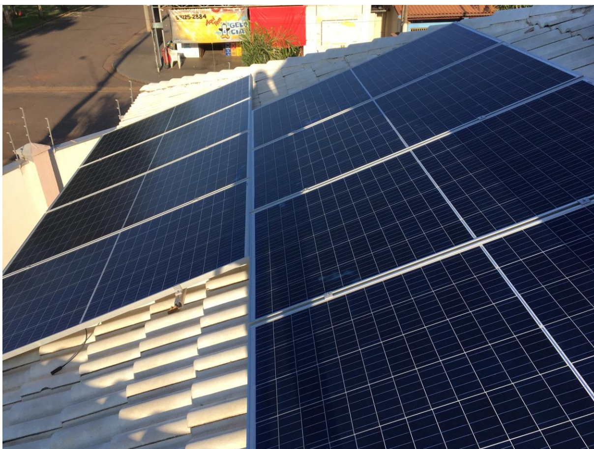
Figura 17: Vista dos módulos da residência de cima (telhado norte).
