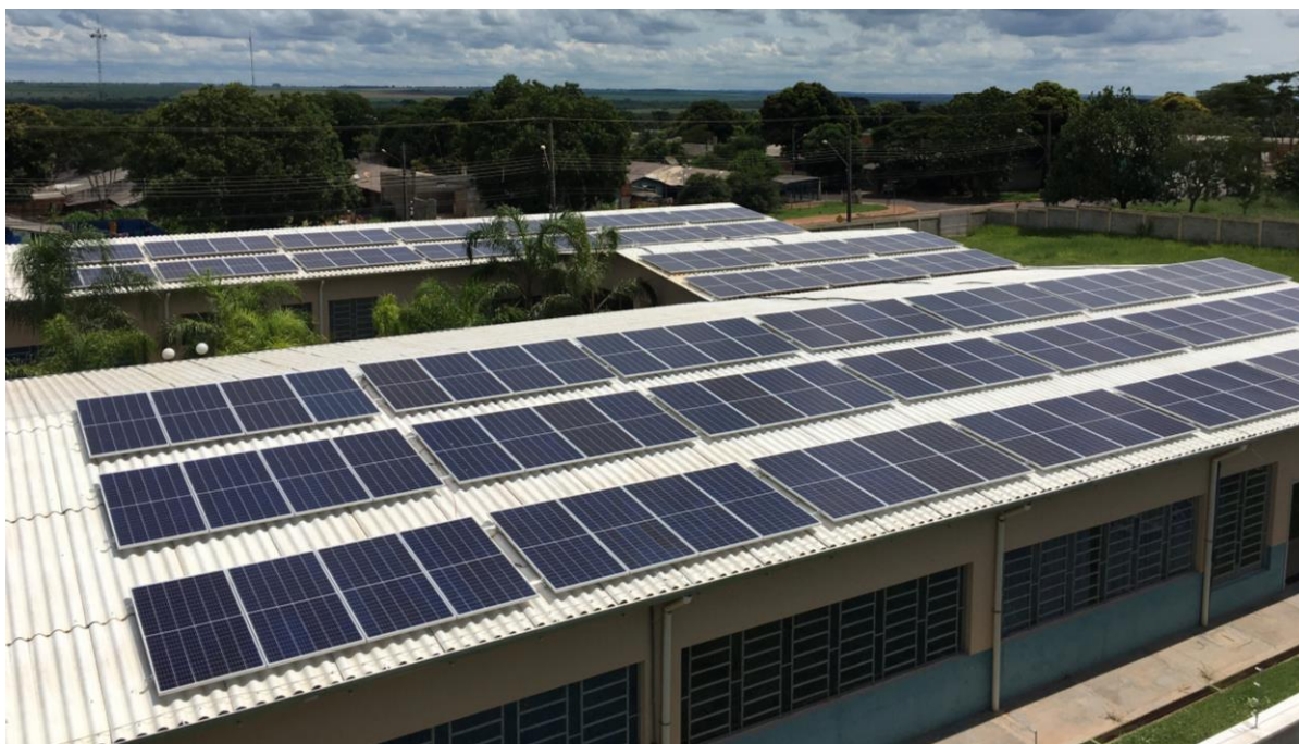
Figura 13: Vista frontal dos módulos fotovoltaicos da entidade.
