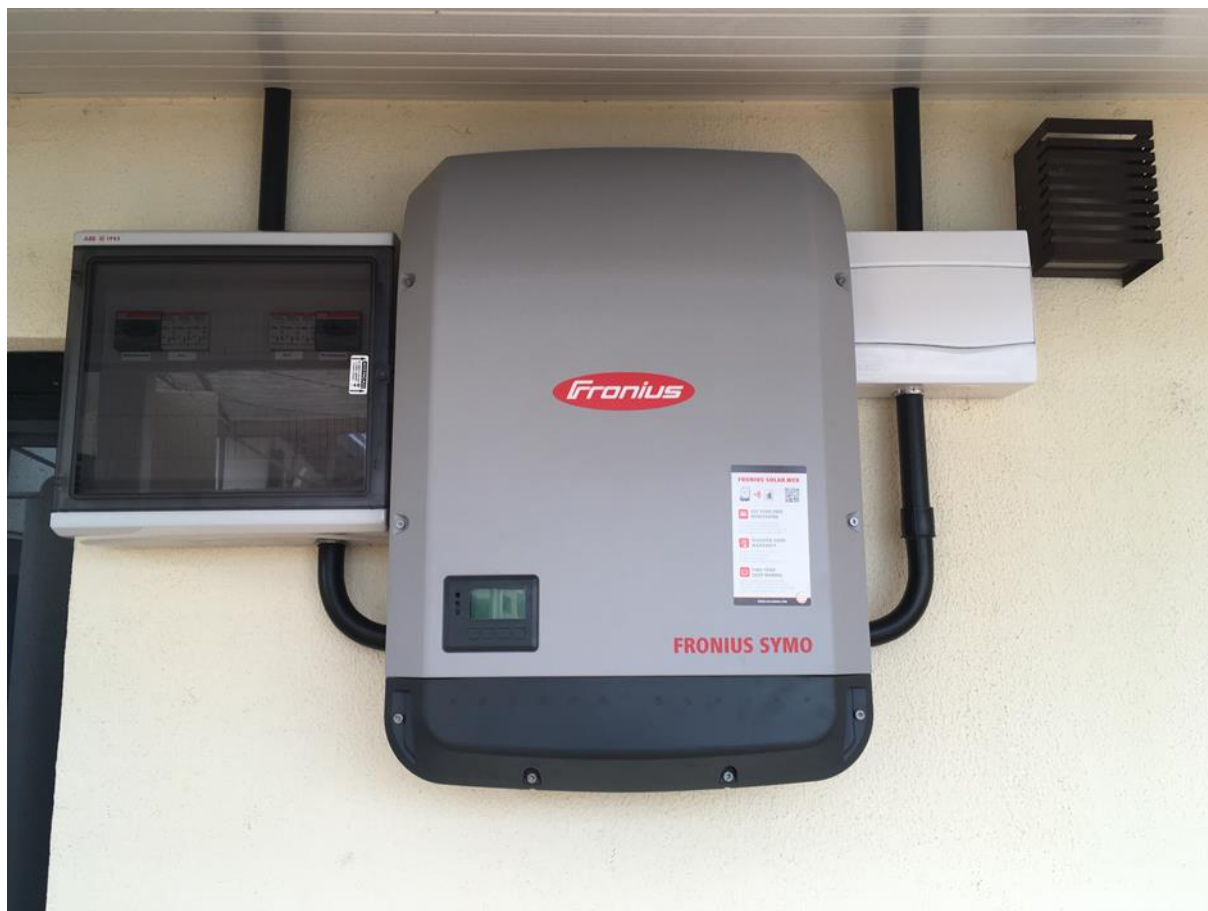
Figura 18: Vista de um dos inversores da residência.
