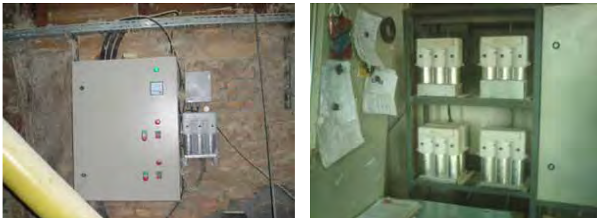
Figura 3. Capacitores instalados na granja.
