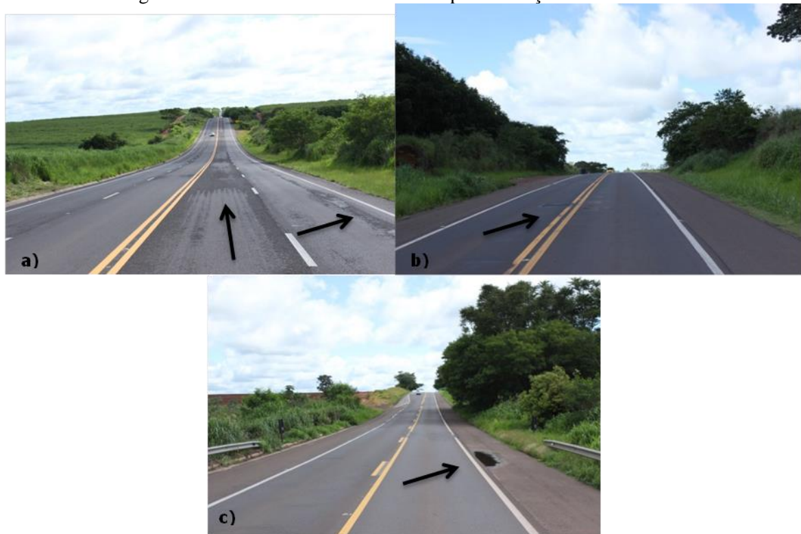
Figura 53 - Fatores contribuintes da via: pavimentação e acostamento.
