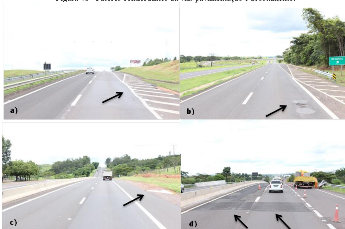
Figura 48 - Fatores contribuintes da via: pavimentação e acostamento.
