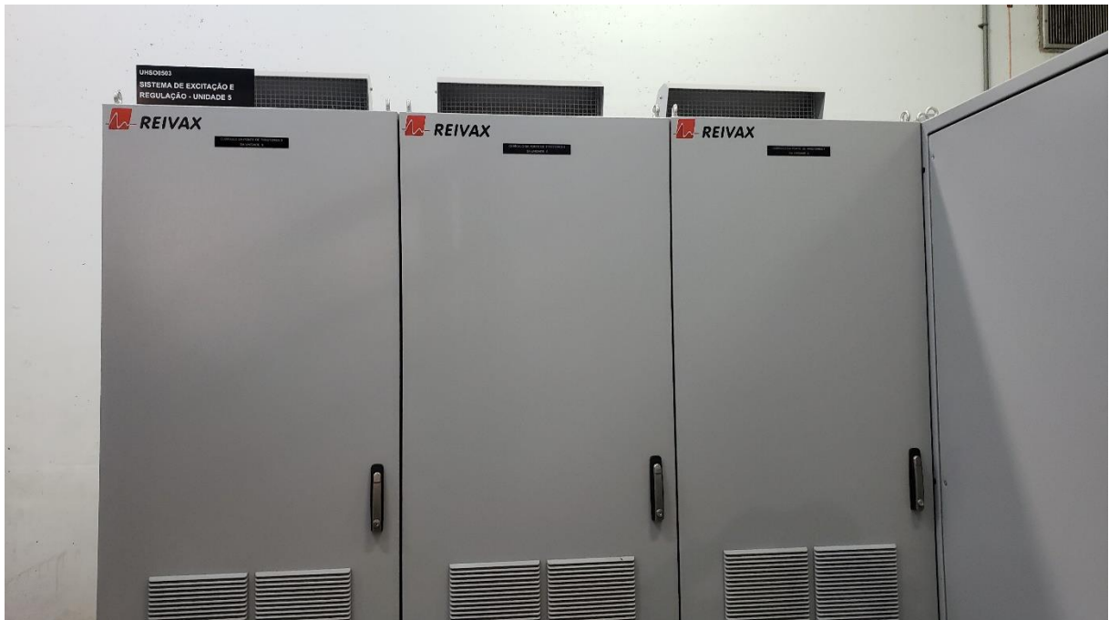
Figura 20 - Cubículos das pontes de tiristores.
