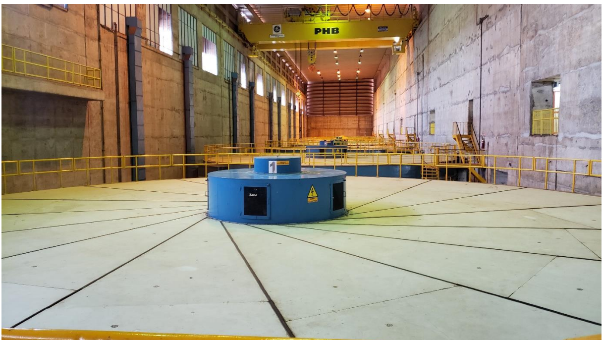
Figura 22 - Carcaça dos anéis coletores - UHE São Simão.
