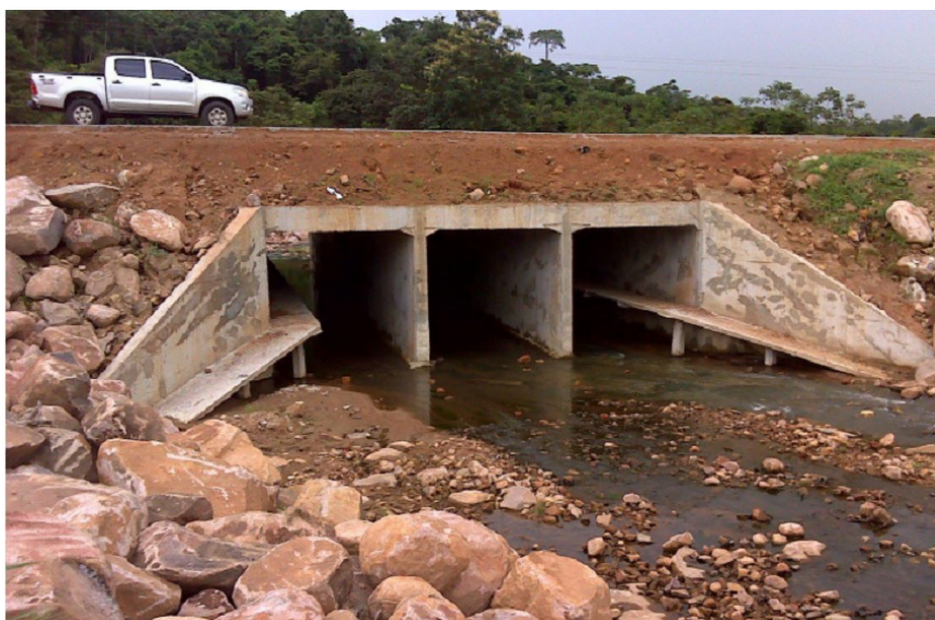
FIGURA 3. Passagem subterrânea do tipo galeria, com passagens secas nas laterais para animais que não se deslocam por água ou ambientes úmidos na BR-158, no município de Confresa (MT). Fonte: Departamento Nacional de Infraestrutura de Transportes (DNIT).
