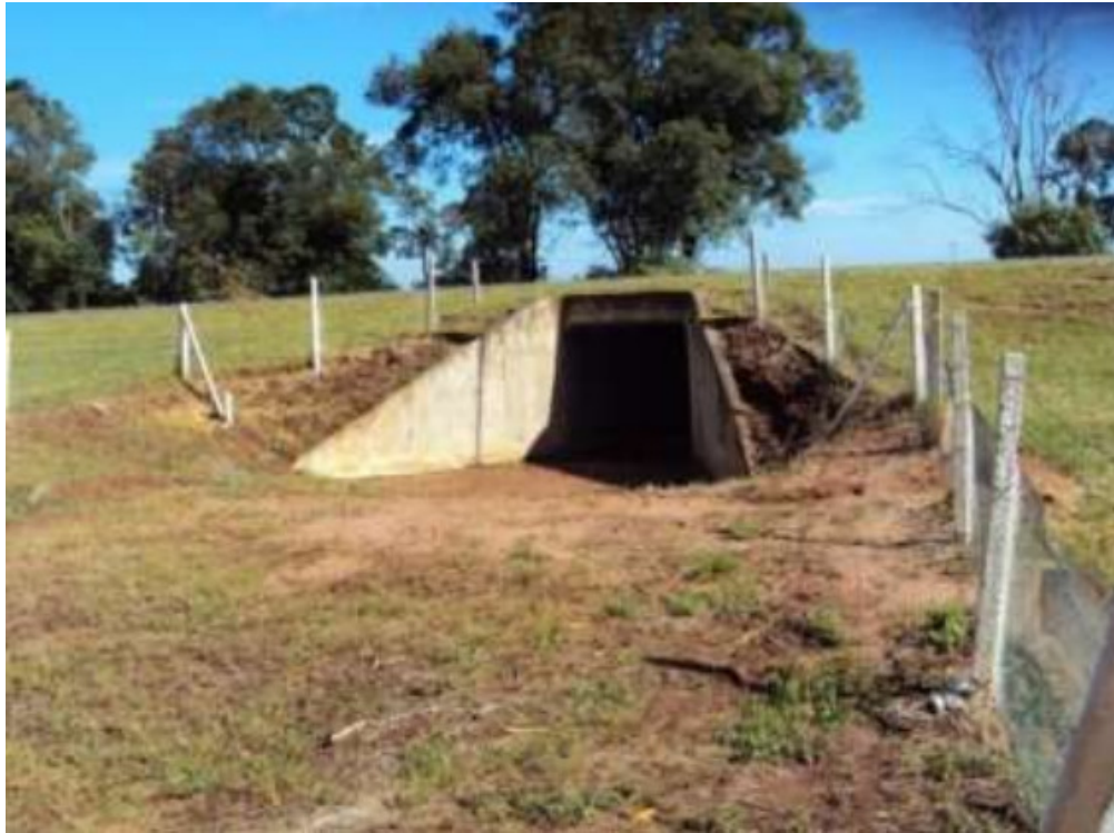
FIGURA 4. Passagem de fauna do tipo caixa seca, acompanhada de cerca condutora, na rodovia SP-225, localizada no município de Brotas (SP). Foto: Fernanda Delborgo Abra.
