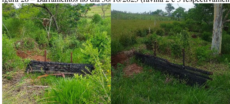
Figura 28 – Barramentos no dia 30/10/2023 (ravina 2 e 3 respectivamente)
