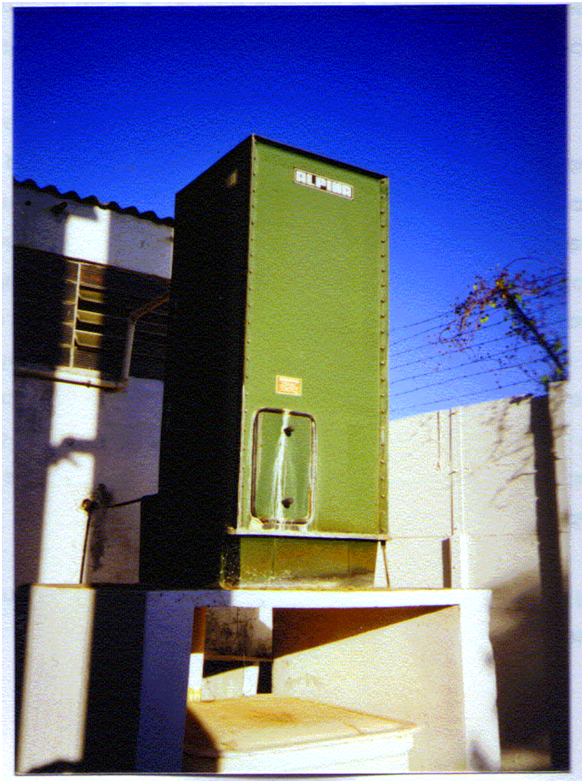
Figura 18 – Torre de resfriamento câmara 01
