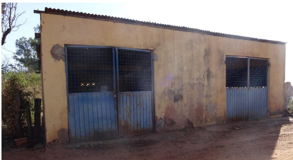
Figura 14. Estrutura que protege um dos tanques de leite do Assentamento Rio Paraná.
