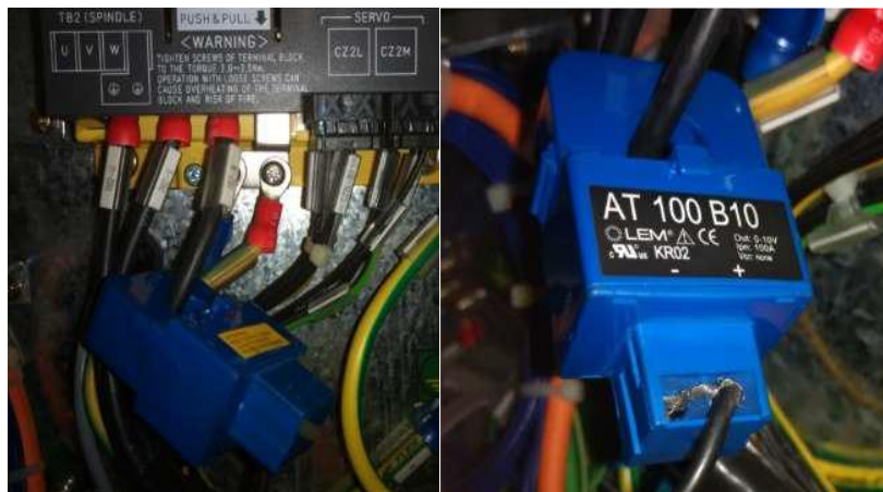
Figura 34 – Transformador de potência LEM modelo AT-100 B10 conectado a uma das fases do motor.
