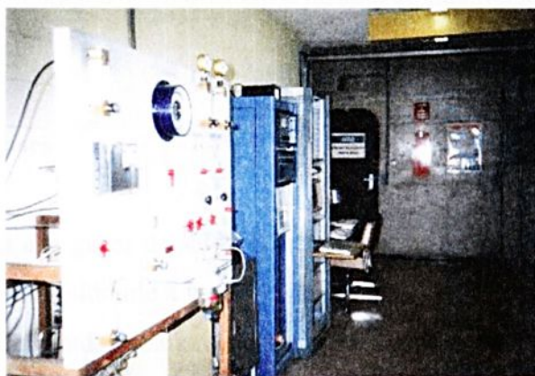
Figura 2.11 – Fotografia da linha de amostragem de gases, com analisadores ao fundo.
