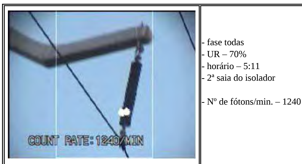
Figura 32 – Imagem de descarga corna em isolador - linha MSD/GRS – Torre 36/8.
