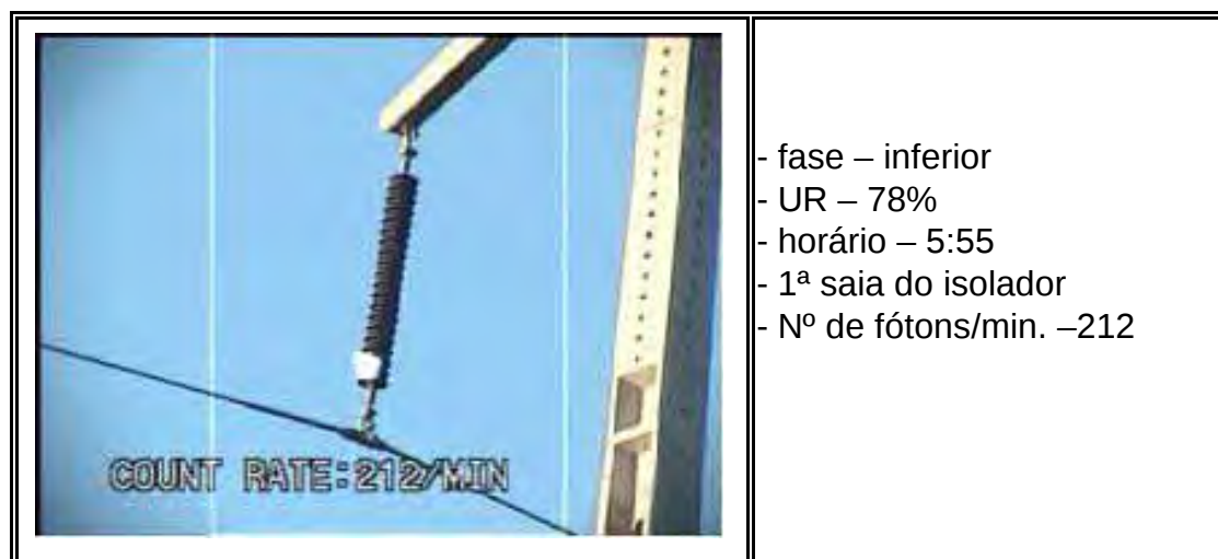
Figura 28 – Imagem de descarga corna em isolador - linha ACD/POL I – Torre 19/4.
