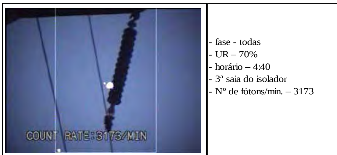
Figura 35 – Imagem de descarga corna em isolador - linha MSD/GRS – Torre 37/1.
