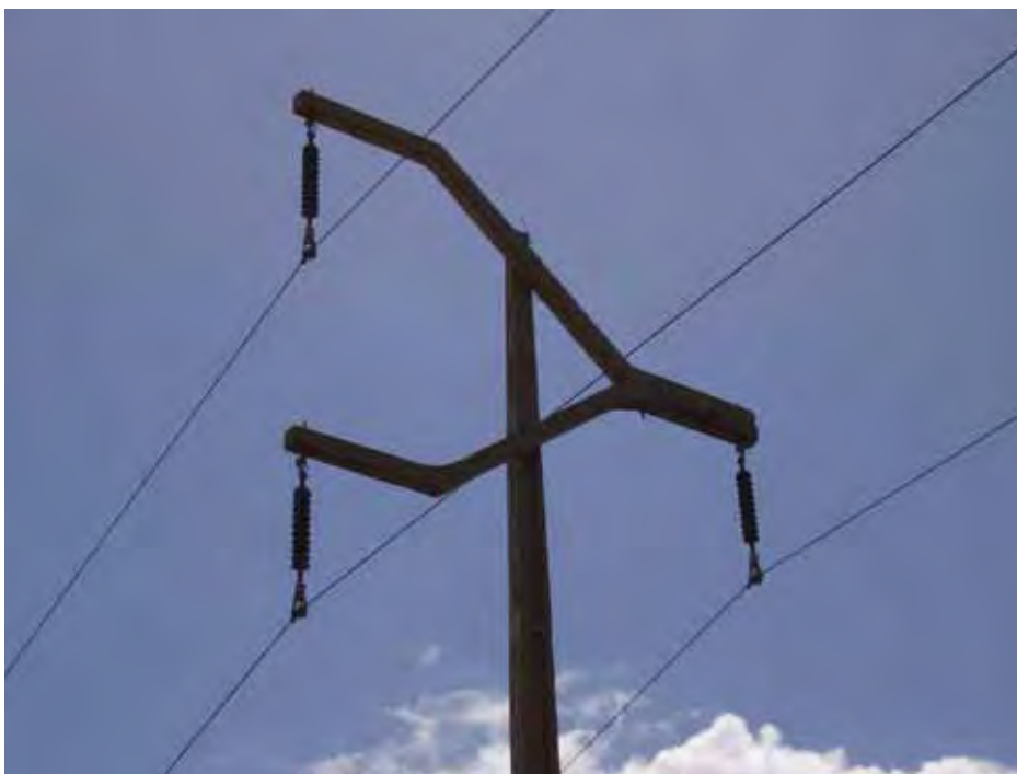
Figura 6 – Poste canadense com 03 fases.
