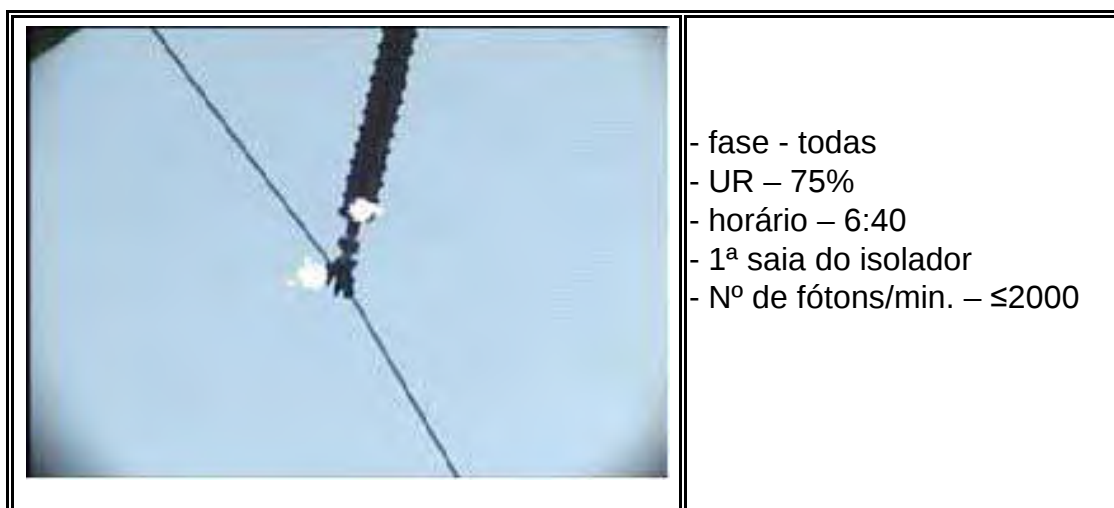
Figura 27 – Imagem de descarga corna em isolador - linha MSD/GRS – Torre 37/1.
