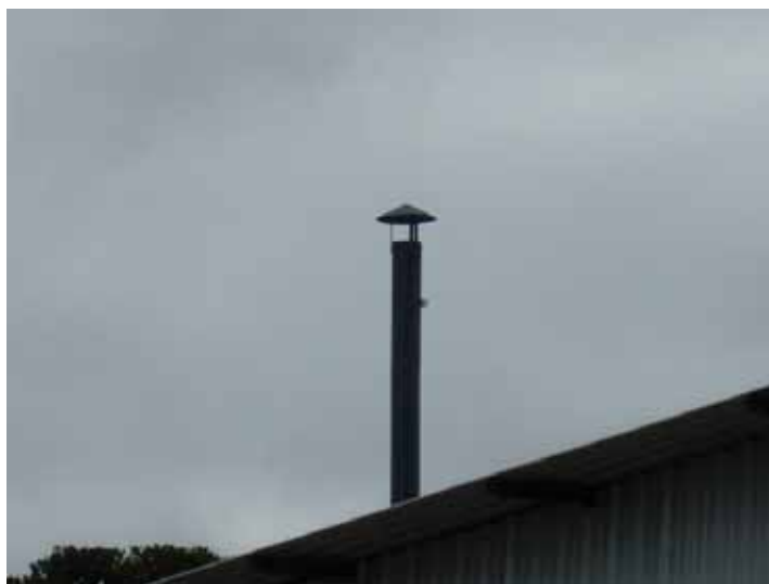
Figura 22. Chaminé para expelir os gases da combustão
