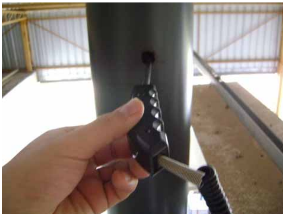
Figura 24. Termo-anemômetro no interior da chaminé.
