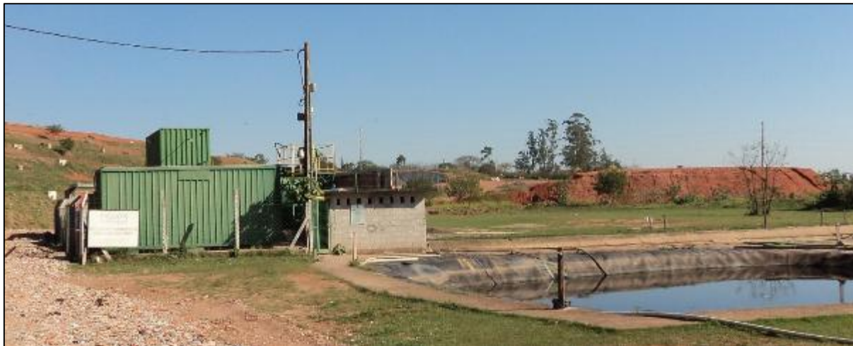
Figura 12 – Estação de Tratamento de Percolado próxima à lagoa de efluente
