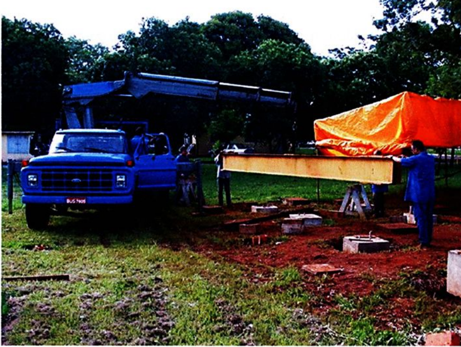
Foto 4.3. Viga de reação.
