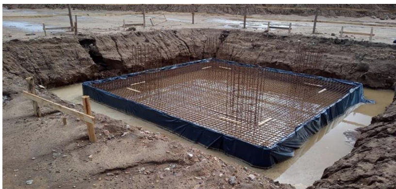
Figura 116 – Fundação de pórtico 500kV alagada após chuva
