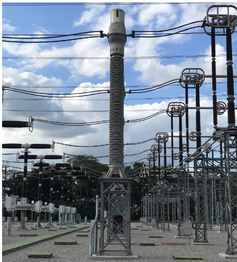
Figura 21 - Transformador de Corrente 500kV instalado em campo
