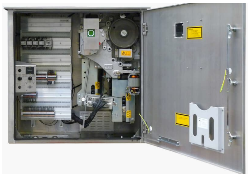
Figura 16 – Armário de comando e mecanismo de acionamento à mola para disjuntor de alta tensão
