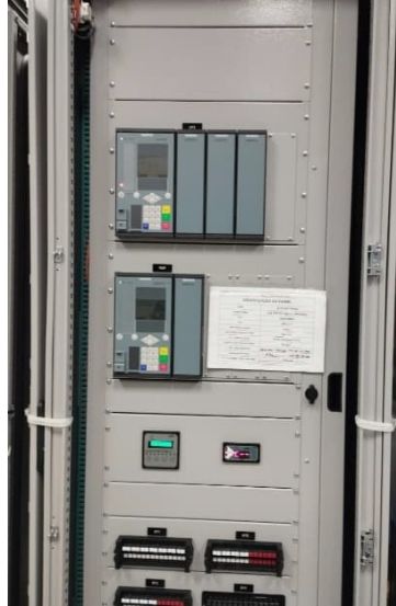
Figura 27 – Vista frontal de painel principal de proteção e controle para transformador de potência em testes
