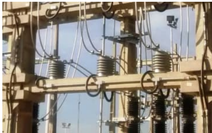
Figura 24 – Transformador de Potencial 34,5kV instalado em campo
