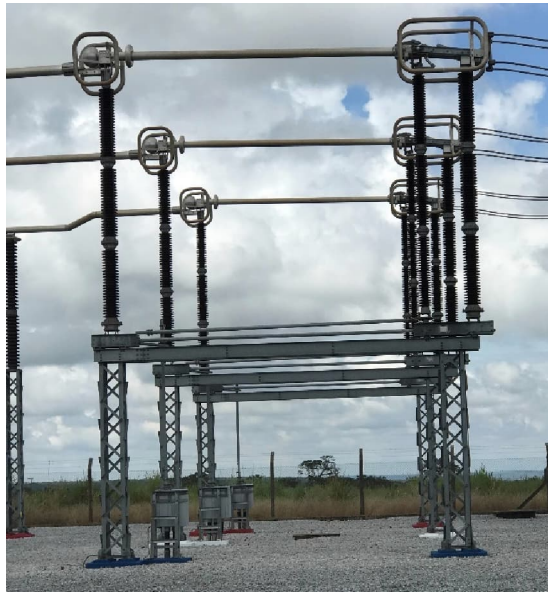
Figura 19 – Chave Seccionadora 500kV instalada em campo
