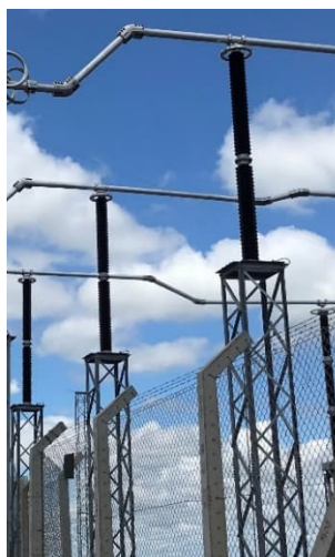
Figura 49 – Isoladores de Pedestal em pátio de 500kV
