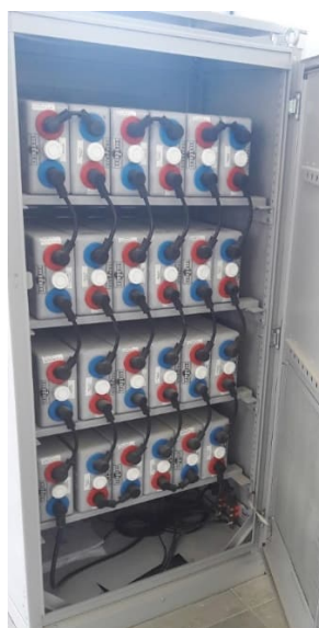
Figura 36 – Banco de Baterias para alimentação CC instalado em campo
