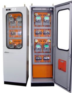
Figura 31 – Pannel de medição de faturamento
