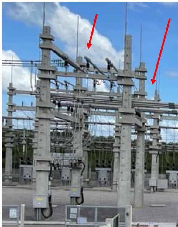
Figura 46 – Tubo de alumínio instalado em subestação para parque eólico
