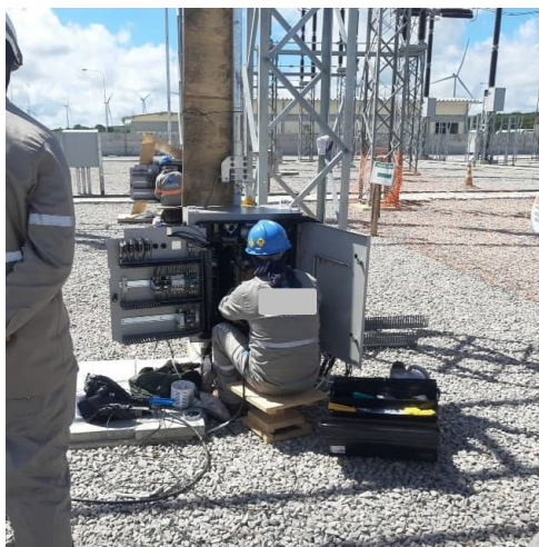
Figura 104 – Conectorização no armário de comando de equipamento
