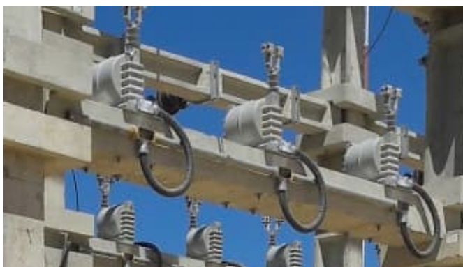
Figura 22 – Transformador de Corrente 34,5kV instalado em campo
