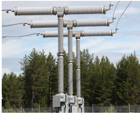
Figura 13 – Disjuntor à SF 6 de alta tensão
