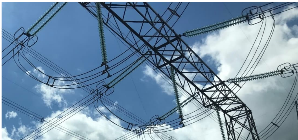
Figura 51 – Isoladores de disco associados às ferragens de fixação do barramento
