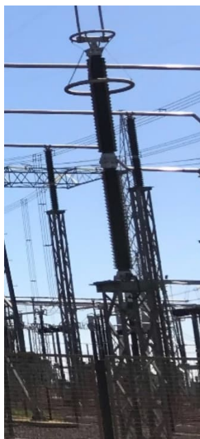
Figura 25 – Para-raio instalado em campo no setor de 500kV
