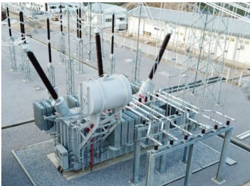
Figura 12 – Transformador 34,5/500 kV em operação
