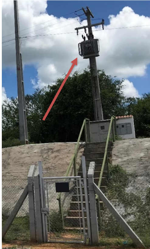
Figura 38 – Transformador de Serviço Auxiliar instalado em rede de distribuidora local para alimentação na subestação
