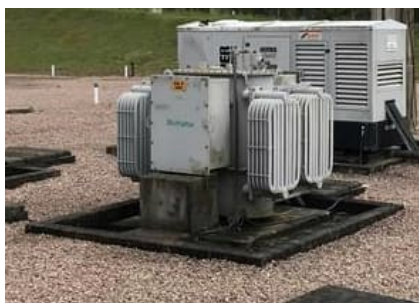
Figura 37 – Transformador de Serviço Auxiliar de pátio
