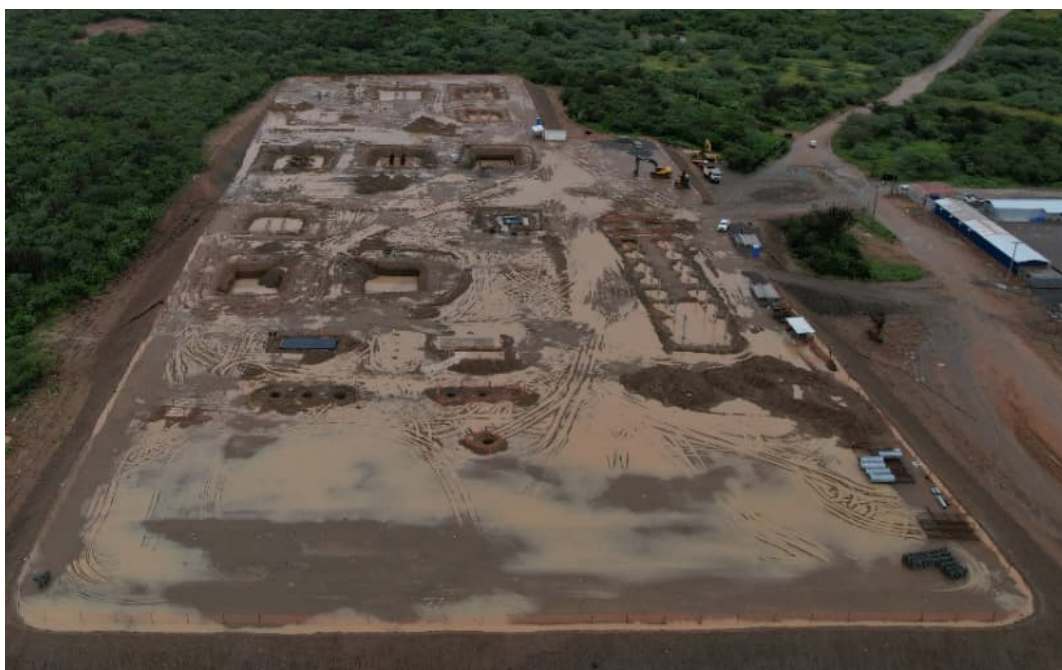
Figura 115 – Área da subestação após chuvas
