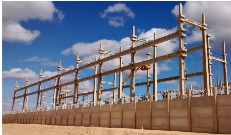
Figura 42 – Pórticos de concreto do setor de 34,5 kV de uma SE aplicada em parque eólico
