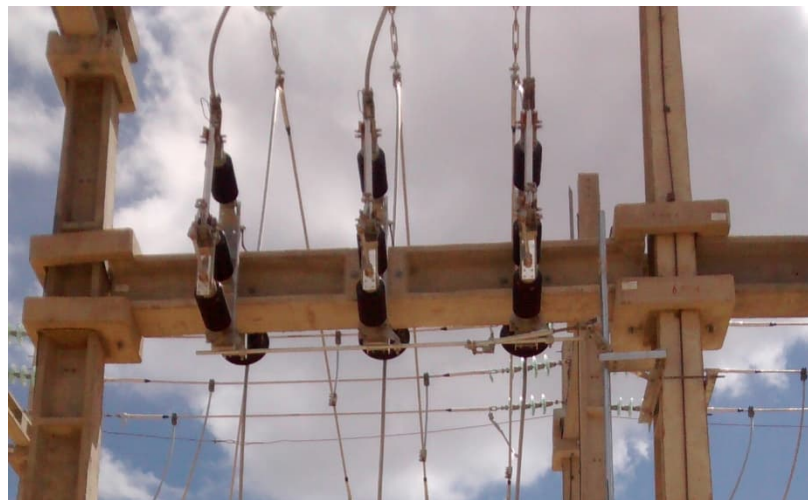
Figura 20 – Chave Seccionadora 34,5kV instalada em campo
