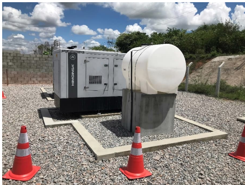
Figura 39 – Grupo motor-gerador com tanque externo instalado em subestação
