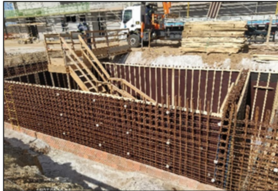
Figura 72 – Caixa separadora de água e óleo para transformadores em execução
