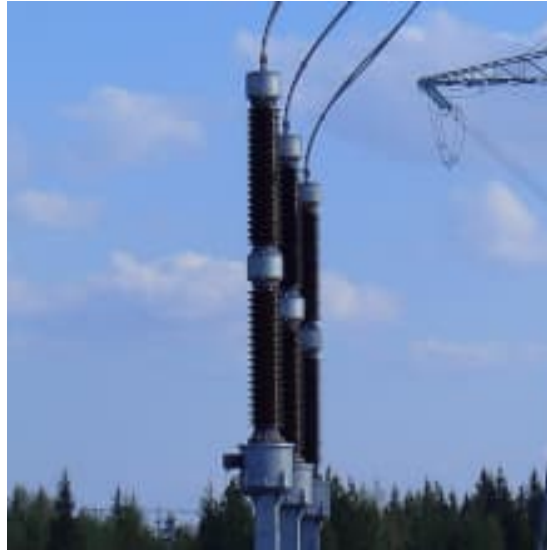
Figura 23 – Transformador de Potencial 500kV instalado em campo
