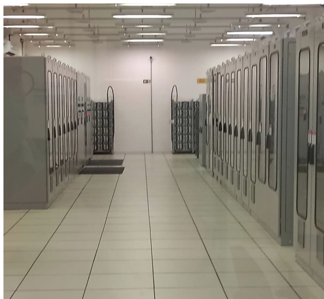
Figura 29 – Sala de painéis real de SE elevadora 34,5/500 kV aplicada a um parque eólico
