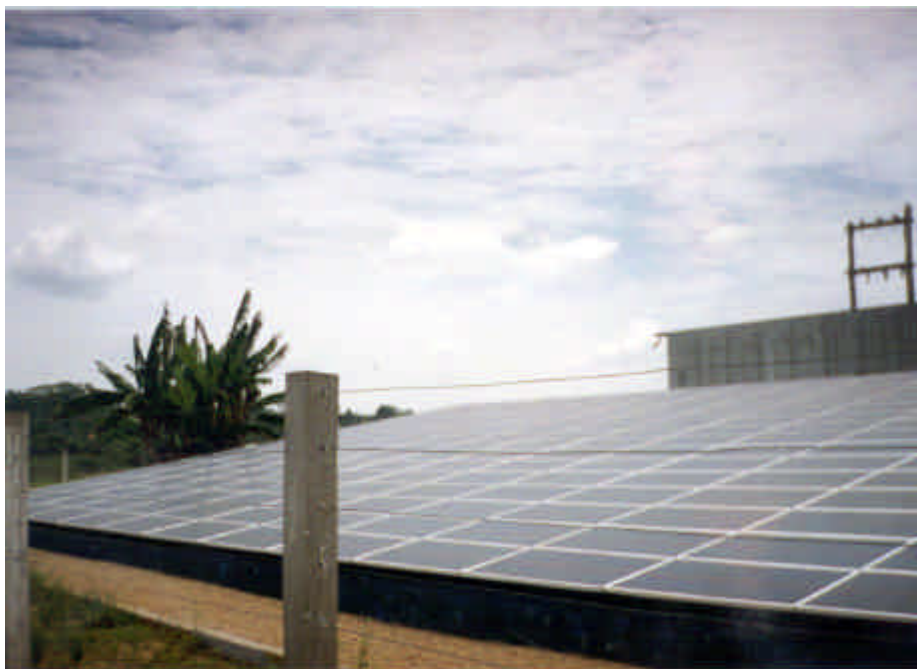
Foto 22 – Placas coletoras de energia solar instaladas na Vila do Araras no ano de 2000.
