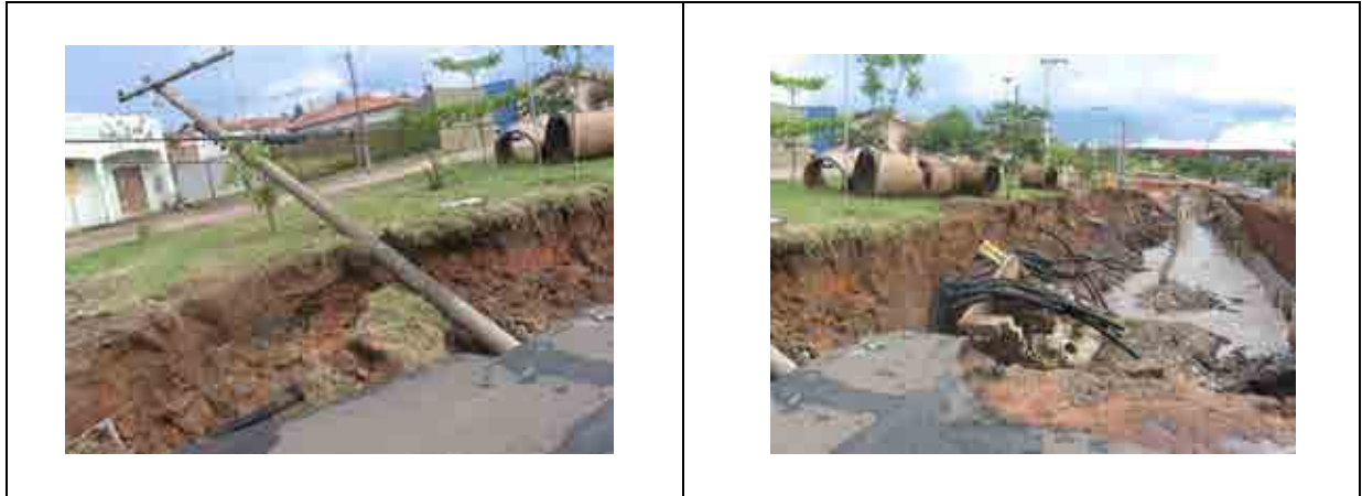
Imagem 7: Situação do Bairro Inocoop após inundação. Acervo pessoal da moradora Denise Oliveira.
