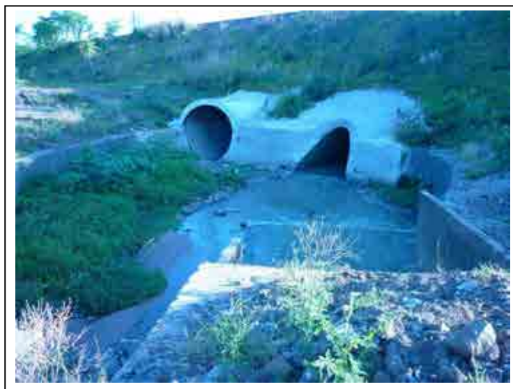
Imagem 15: Presença de sedimentos na margem esquerda do Córrego da Servidão em frente a obra de contenção de enchentes.
