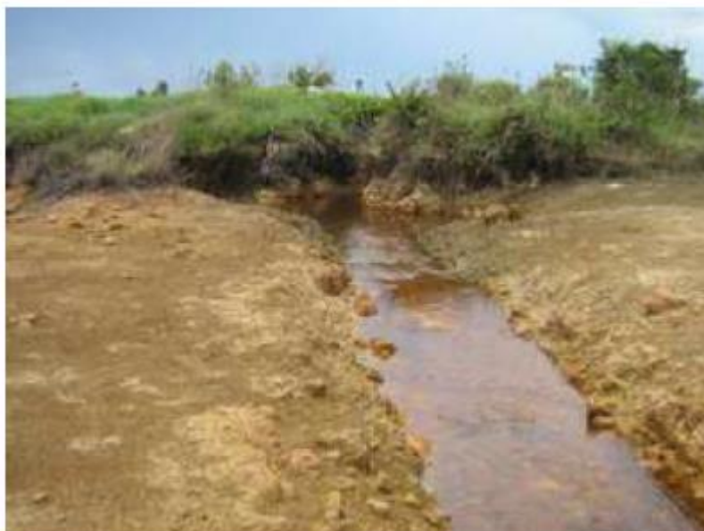
Figura 20 Rompimento do talude de um biótopo úmido na área Tijuco.
