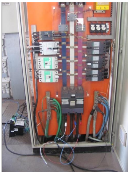
Figura 59 – Foto de um dos quadros de distribuição onde foram feitas medições
