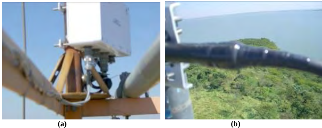
Figura A.43 – (a) Detalhe da fixação dos cabos que saem da Caixa Eletrônica e (b) Isolamento com fita auto-fusão envolvida por fita isolante na Antena
