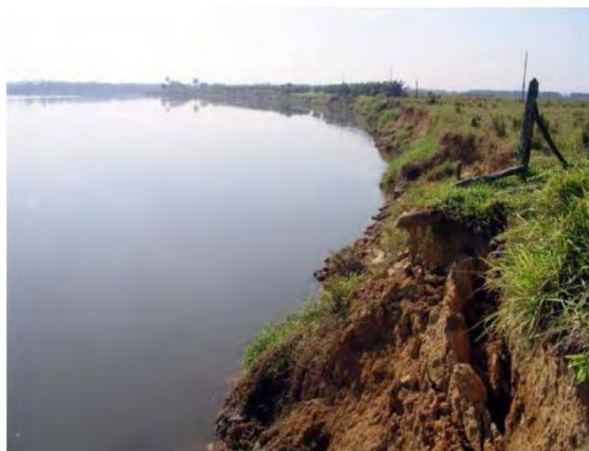
Figura 4.1 – Processos erosivos nas margens da barragem de Ilha Solteira
