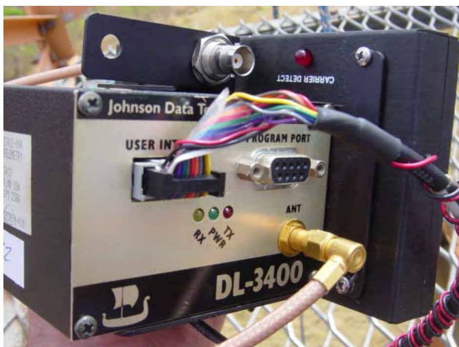
Figura A.12 – Novo modem, vista das conexões frontais
