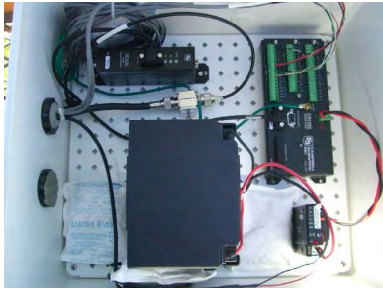
Figura A.44 – Caixa de proteção em sua configuração final
