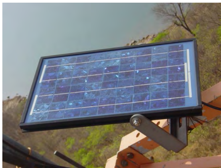
Figura A.16 – Painel solar utilizado em campo
