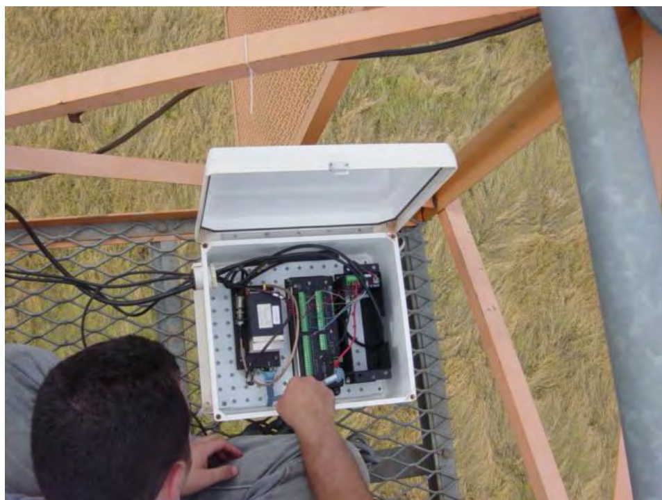
Figura A.14 – Novo modem, instalado
