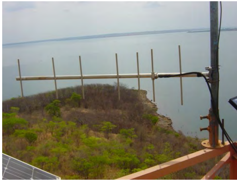
Figura A.15 – Antena transmissora utilizada no campo
