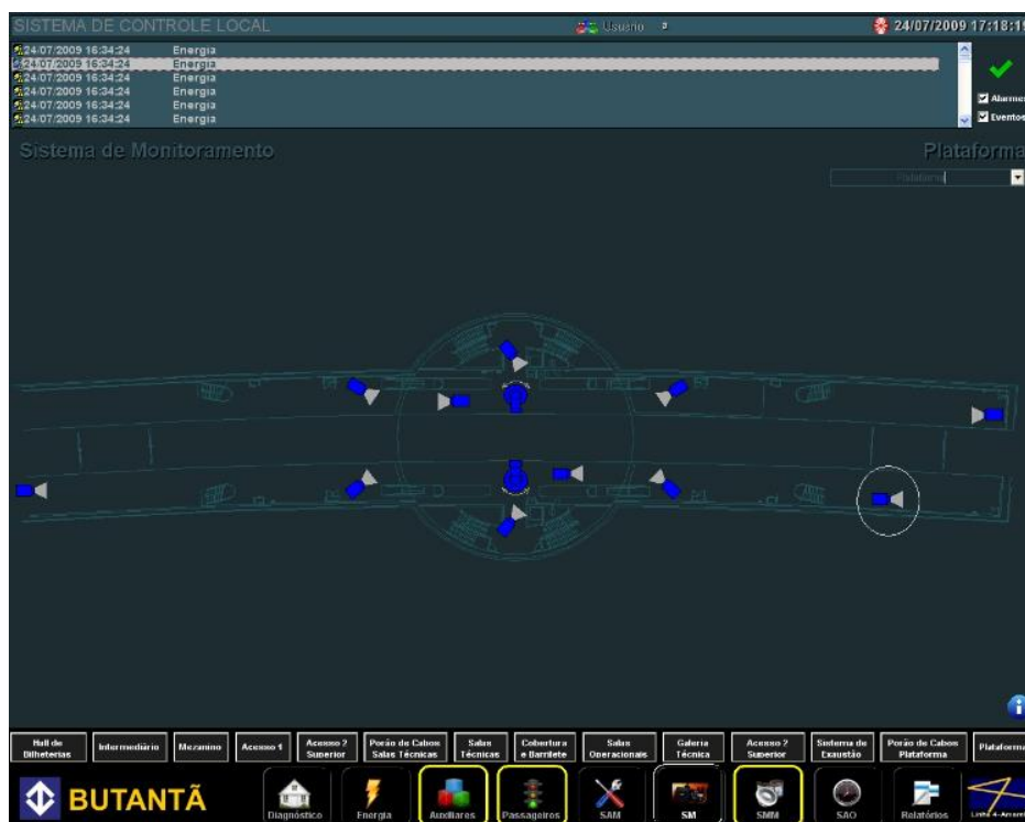
Figura 30 - Supervisório Local da estação Butantã exibindo a tela do sistema de monitoramento da plataforma.
