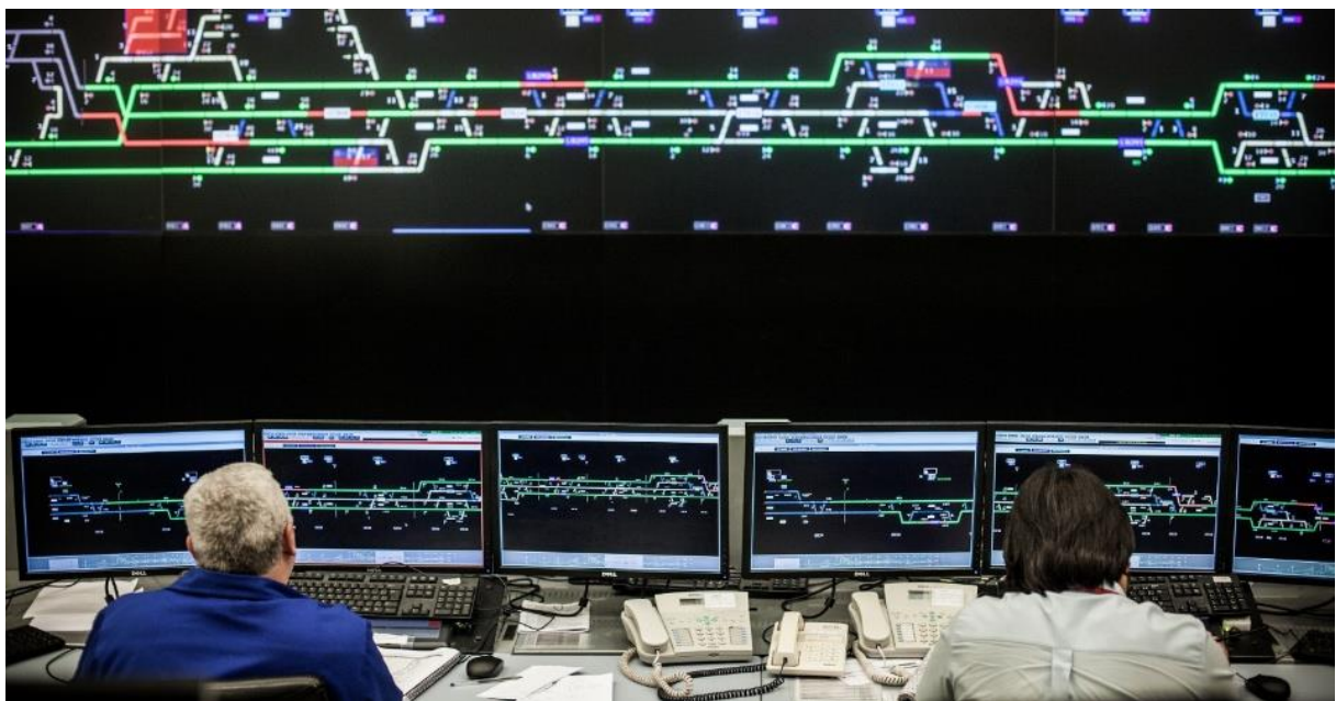
Figura 25 – Postos de monitoramento e painel sinótico de supervisão global dos sistemas de sinalização.
