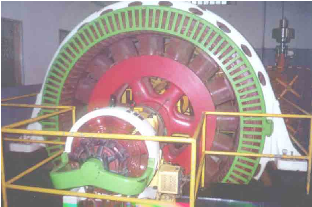
Figura 5 : Gerador : Vista parcial interna da UHE Gavião Peixoto
