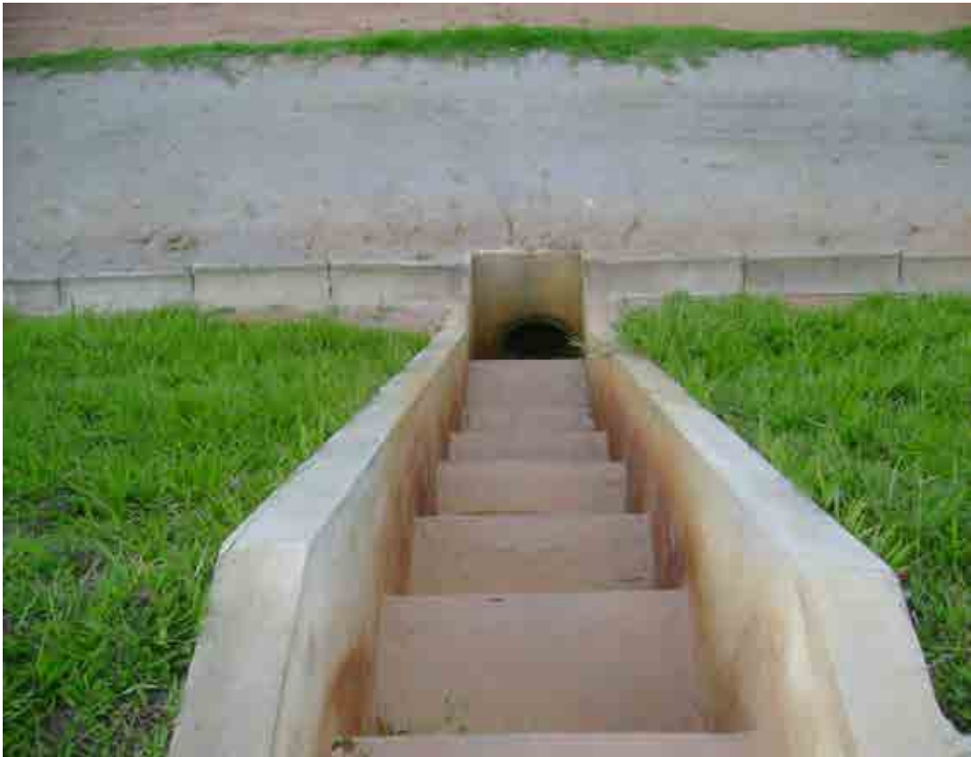
Figura 10 - Drenos para águas pluviais (Fonte: www.valesolucoesambientais )
