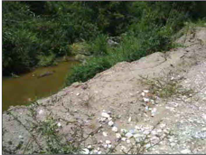
Figura 20: Instabilidade do talude devido a falta do sistema de drenagem. (Fonte: Autor)
