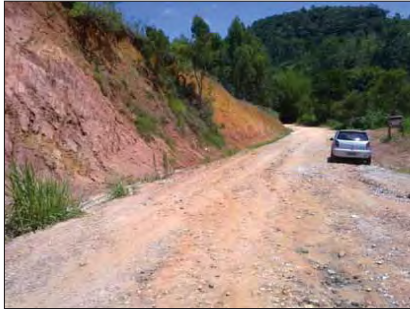
Figura 8: Foto de trecho plano composto de argila siltosa com sistema drenante não funcional na estrada Santa Cruz do Rio Abaixo. (Fonte Autor)
