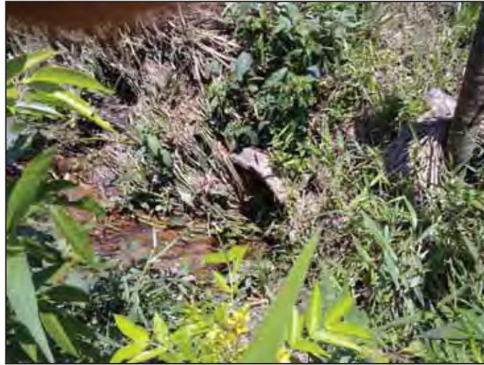
Figura 24: Sistema de drenagem obstruído pela vegetação. (Fonte: Autor)
