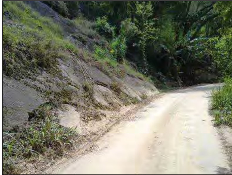
Figura 7: Foto de trecho plano composto de argila siltosa com sistema drenante não funcional na estrada Santa Cruz do Rio Abaixo. (Fonte: Autor)
