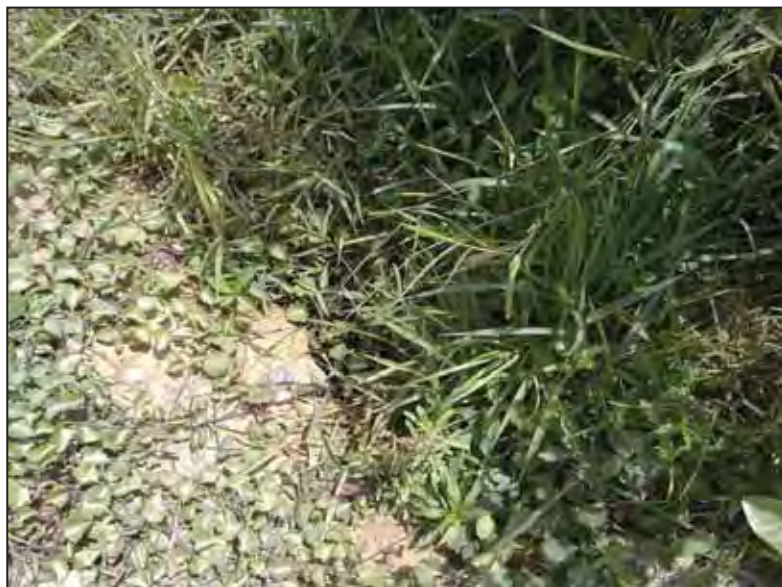
Figura 21: Bueiro obstruído pela vegetação. (Fonte: Autor)
