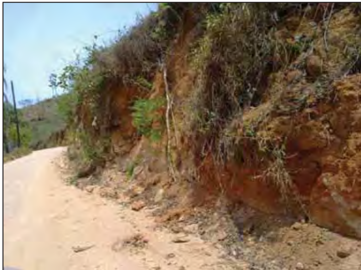
Figura 19: Implantação de estrada vicinal sem a devida atenção ao equilíbrio ambiental. (Fonte: Autor)
