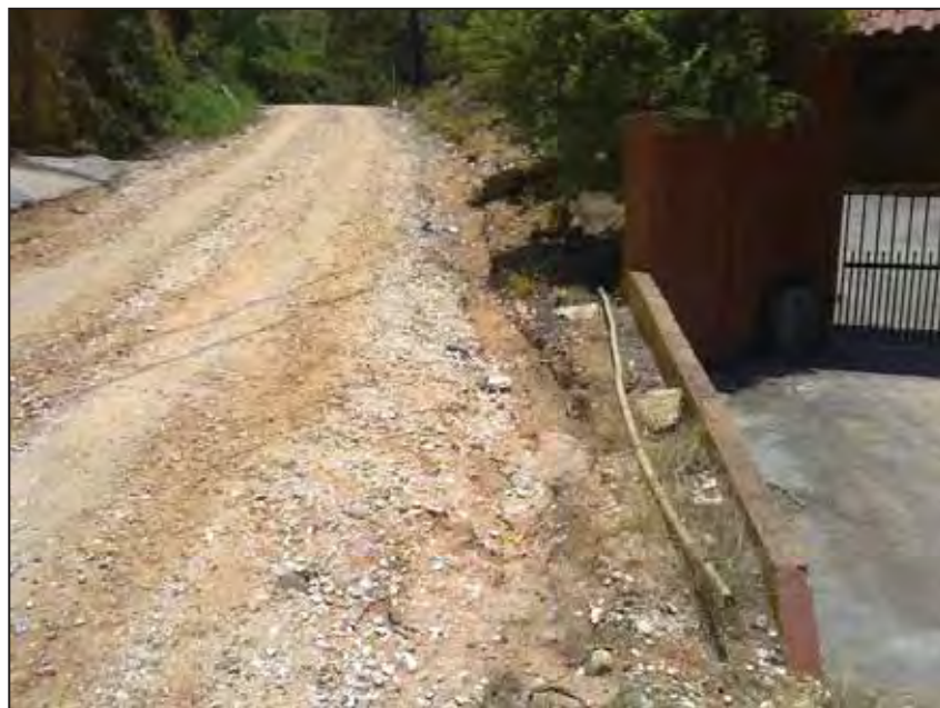
Figura 18: Trecho com baixa aderência devido a falha no encascalhamento. (Fonte: Autor)
