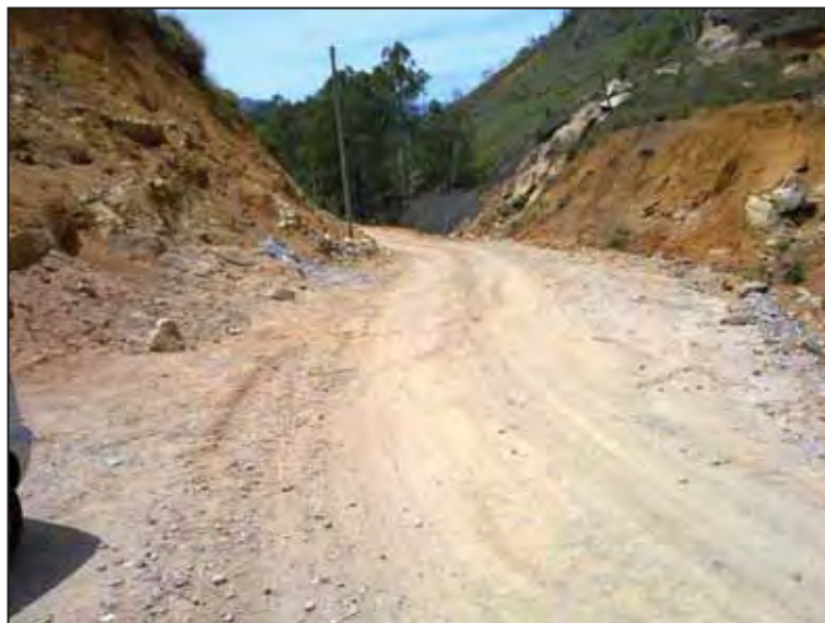
Figura 22: Trecho com pista derrapante, sem abaulamento e com sistema de drenagem inexistente. (Fonte: Autor)
