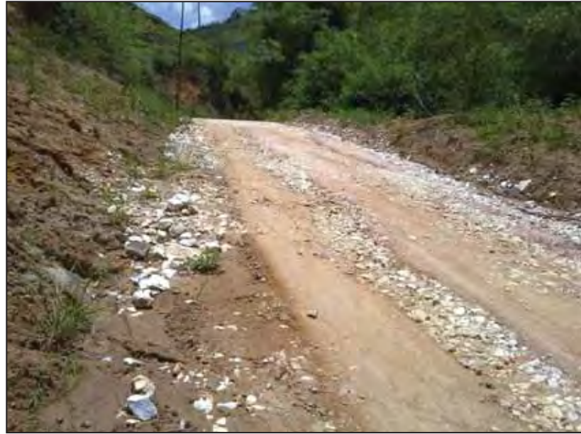
Figura 5: Exemplo de uma estrada vicinal com sistema de drenagem não adequado.
