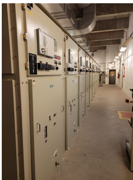
Figura 4 — Cubículos de proteção e medição dos circuitos
