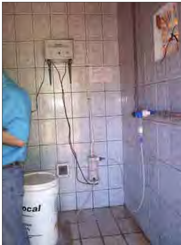
Fotografia 7. Sistema de cloração “Hidrogerox®” e dosador de cloro à direita na parede.
