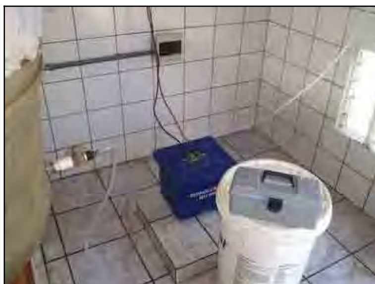
Fotografia 6. Sistema de cloração/desinfecção “Hidrogenox®”
