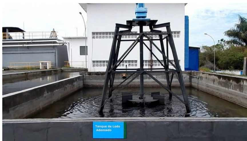
Figura 9 - Tanque de lodo adensado por gravidade
