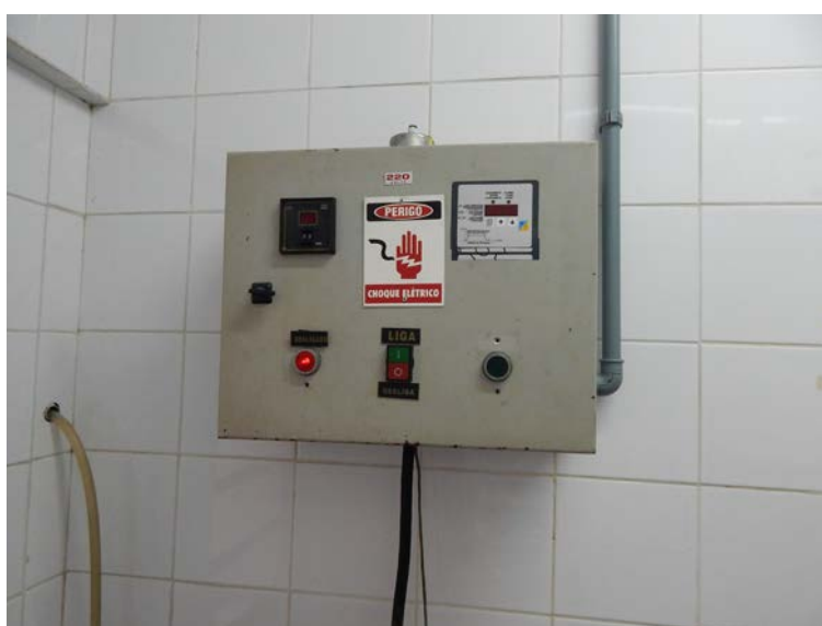
Figura 13 - Controlador da autoclave
