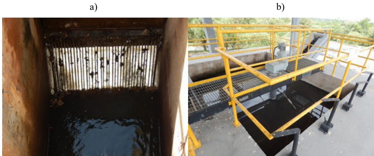
Figura 4 - a) Grade para separação primária e b) Separador de areia
