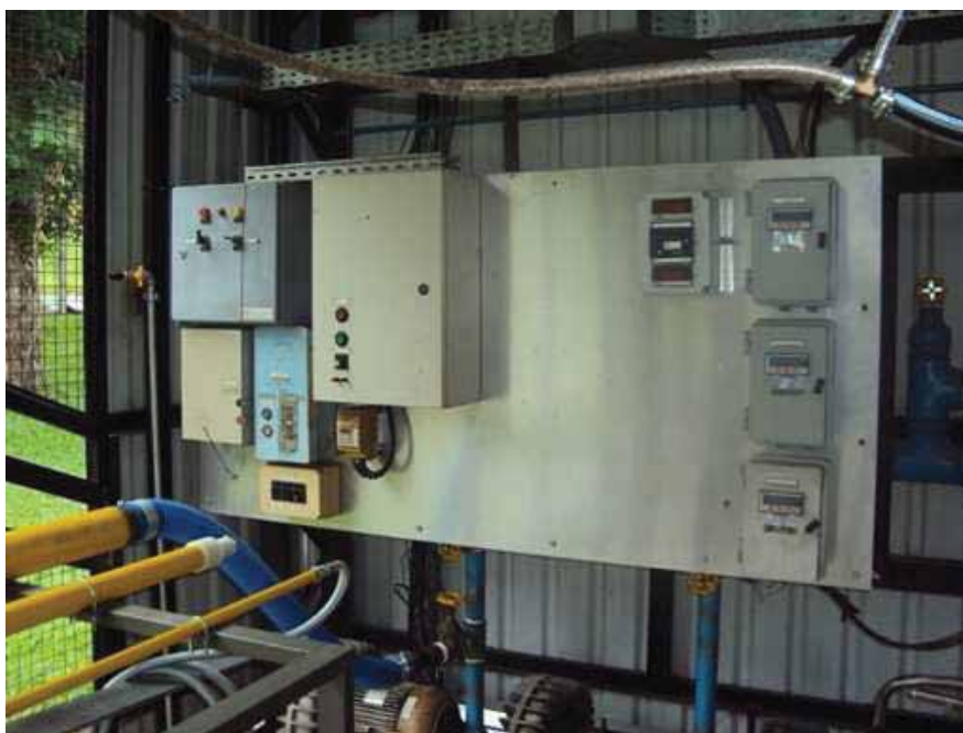
Figura 26 – Painel de controle dos compressores e da bomba KSB.
