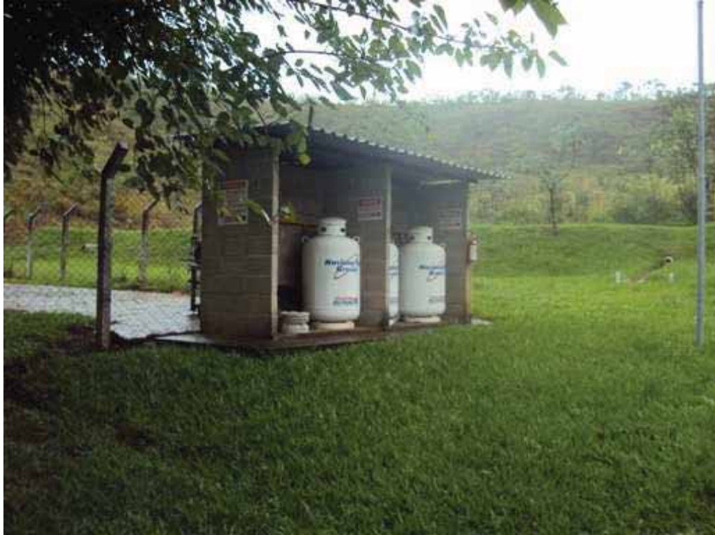
Figura 24 – Cilindros de GLP da National Gás Granel
