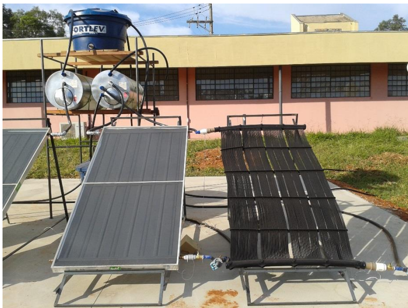
Figura 26 – Sistema acoplado de aquecimento de água instalado.
