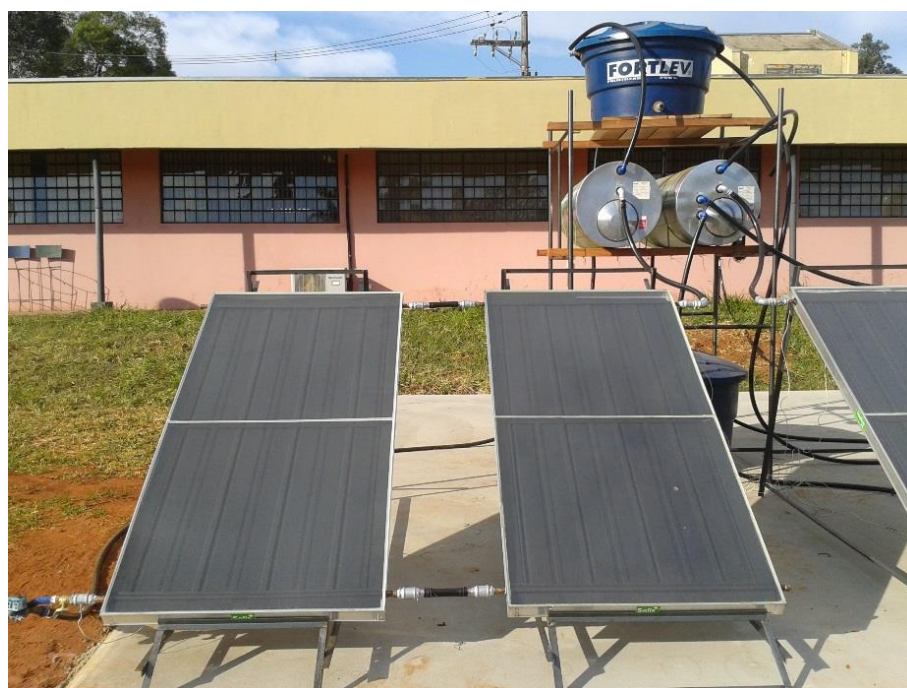
Figura 24 – Sistema simples de aquecimento de água instalado.
