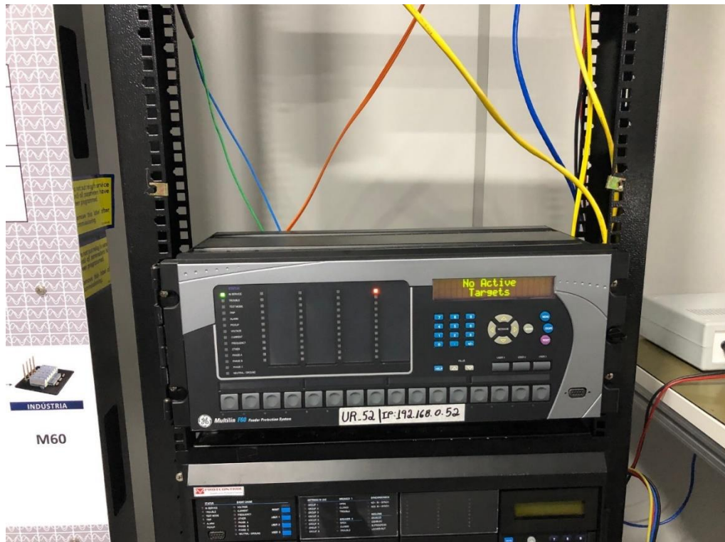
Figura 17 - Relé de Proteção GE Multilin UR-F35-2 (Barra 671).
