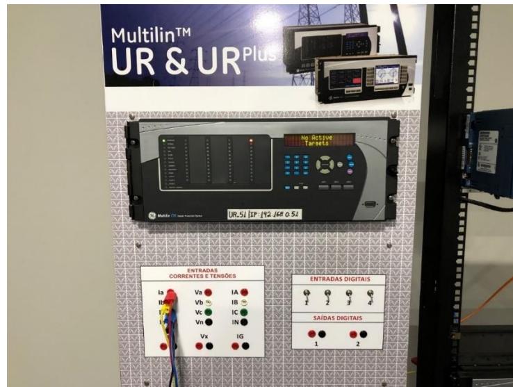
Figura 16 - Relé de Proteção GE Multilin UR-F35-1 (Barra 632).
