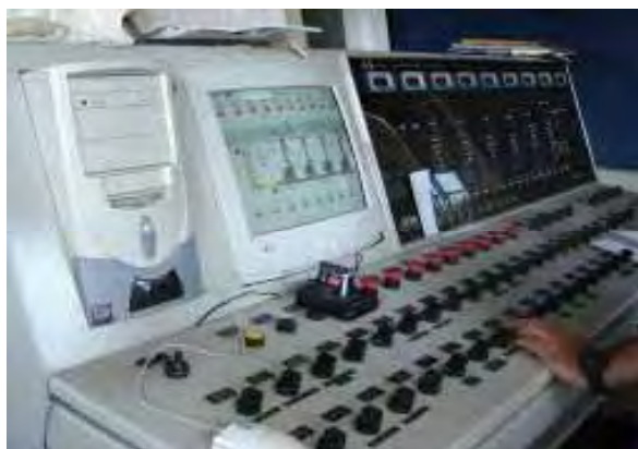
Figura 50. Painel da Central de Monitoração.
