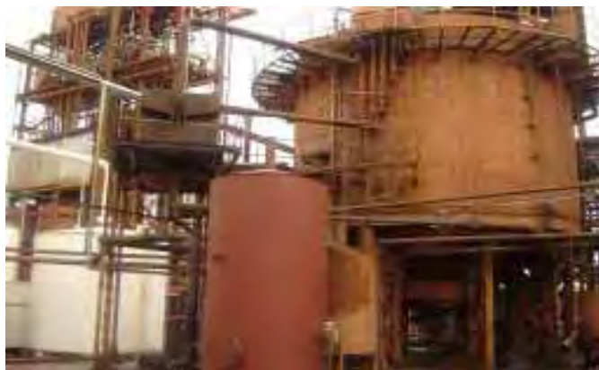
Figura 56. Vista do decantador de caldo.
