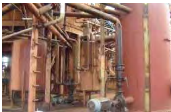
Figura 57. Vista dos tanques 1 e 2, após saída do decantador de caldo.
