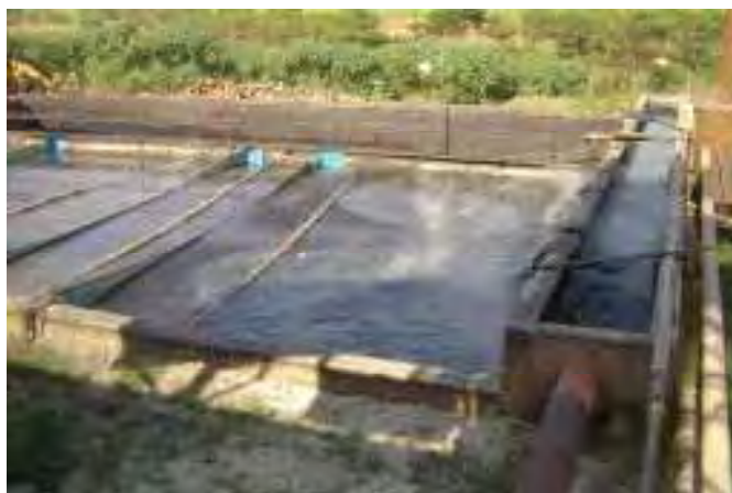
Figura 55. Tanque depósito de resíduos.
