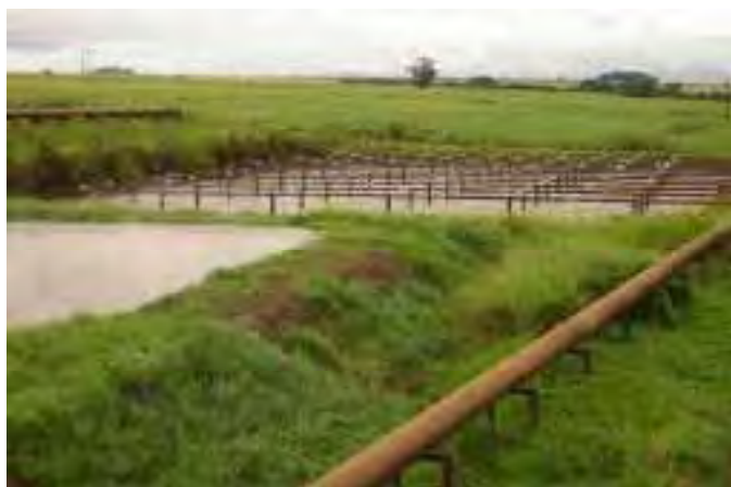
Figura 3. Tanque depósito de vinhaça.
