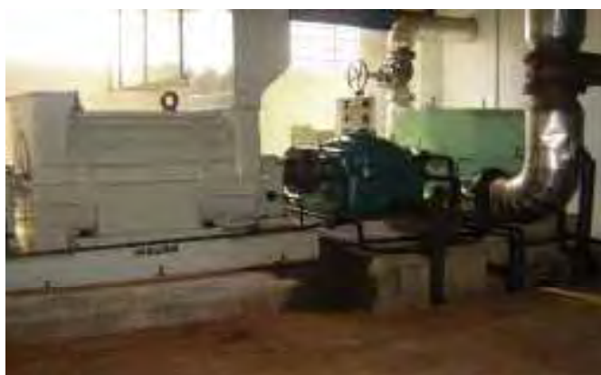
Figura 54. Sala do gerador de energia elétrica.
