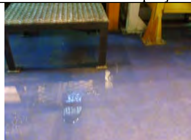
(j1) Vazamento proveniente da compressão de ar
