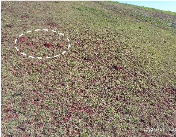
Figura 59: Talude de jusante MD - colônias de formigas, vista 1.
