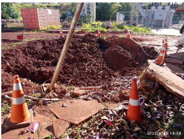
Figura 34: Casa de Bombas - erosão observada na região.
