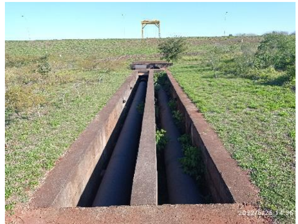
Figura 48: Tomada d'água – vegetação presente nas adutoras de água bruta, vista 2.
