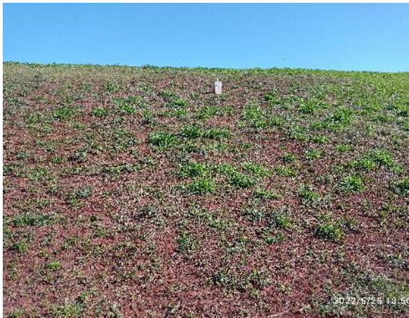
Figura 61: Talude de jusante MD - falha na cobertura vegetal.
