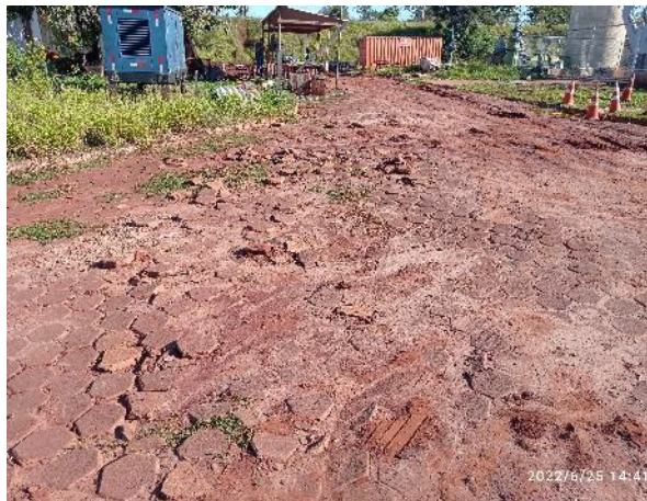
Figura 26: Infraestrutura – exemplo de prejuízo pontual no pavimento de acesso interno.
