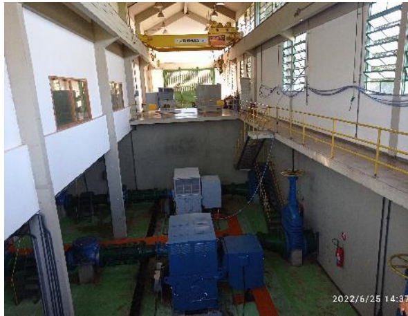
Figura 28: Casa de bombas – visão do interior da casa de bombas.
