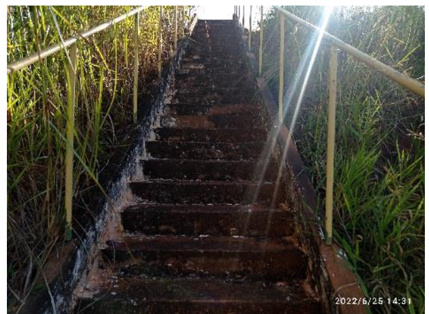
Figura 35: Infraestrutura – escada de acesso com vegetação crescente ao redor.
