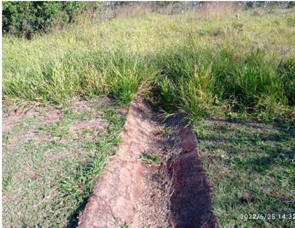
Figura 32: Infraestrutura – canaletas de drenagem obstruídas, vista 1.
