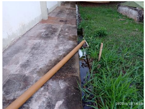
Figura 31: Infraestrutura – região da casa de bombas afetada pela água, vista 2
