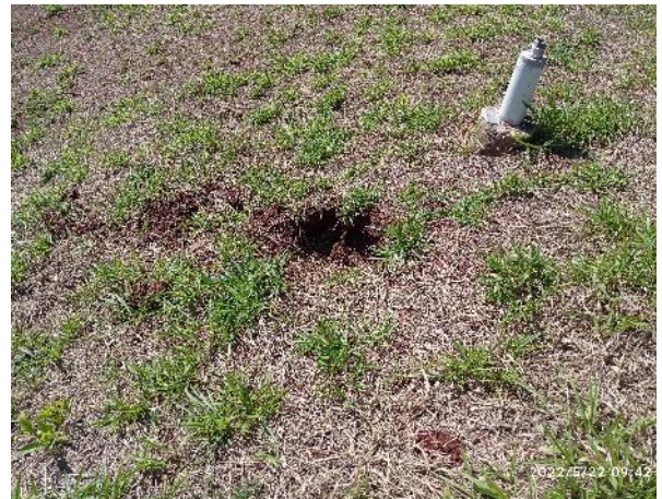
Figura 62: Talude de jusante MD - buraco originado pela retirada de uma colônia de cupim.
