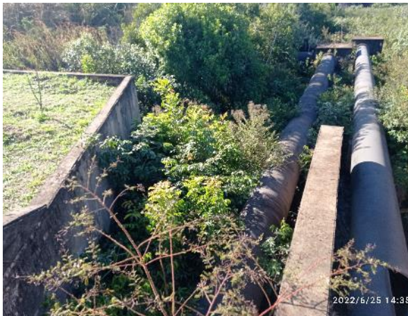
Figura 47: Tomada d'água – vegetação presente nas adutoras de água bruta, vista 1.
