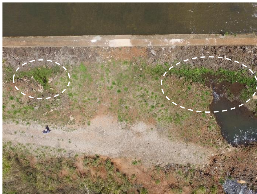
Figura 112 - Pontos de surgência
