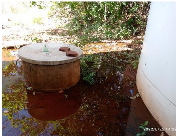
Figura 30: Infraestrutura – região da casa de bombas afetada pela água, vista 1.
