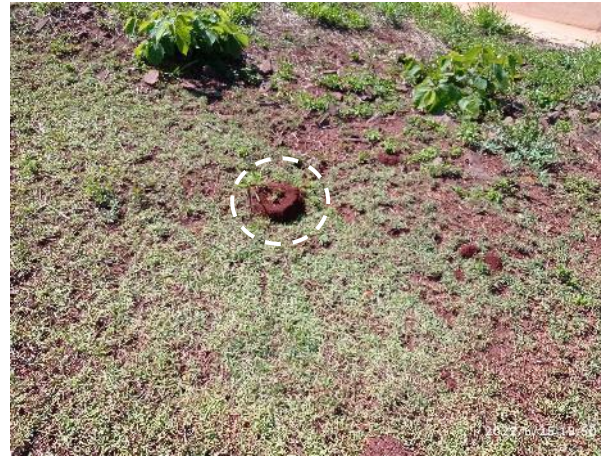
Figura 60: Talude de jusante MD - colônias de formigas, vista 2.
