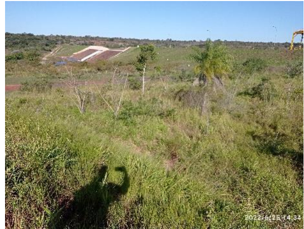
Figura 33: Infraestrutura – canaleta de drenagem obstruídas, vista 2.
