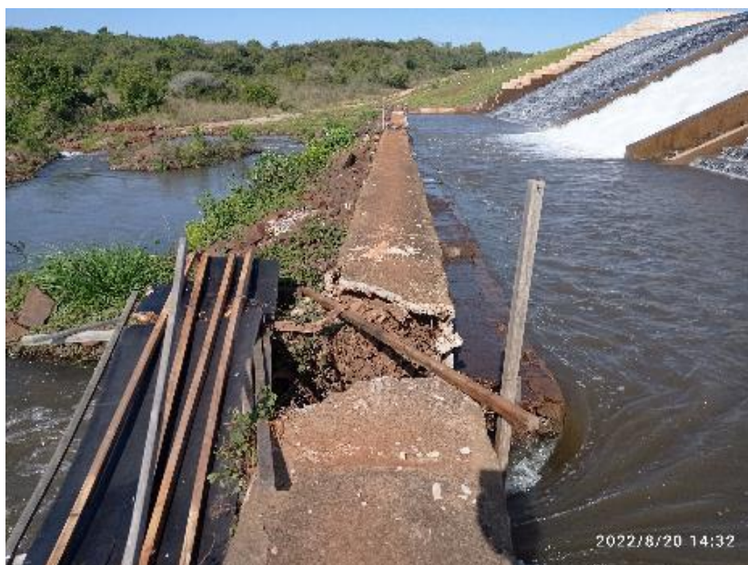
Figura 111 - Ponte quebrada e entulhos, retratada no relatório da inspeção de agosto.
