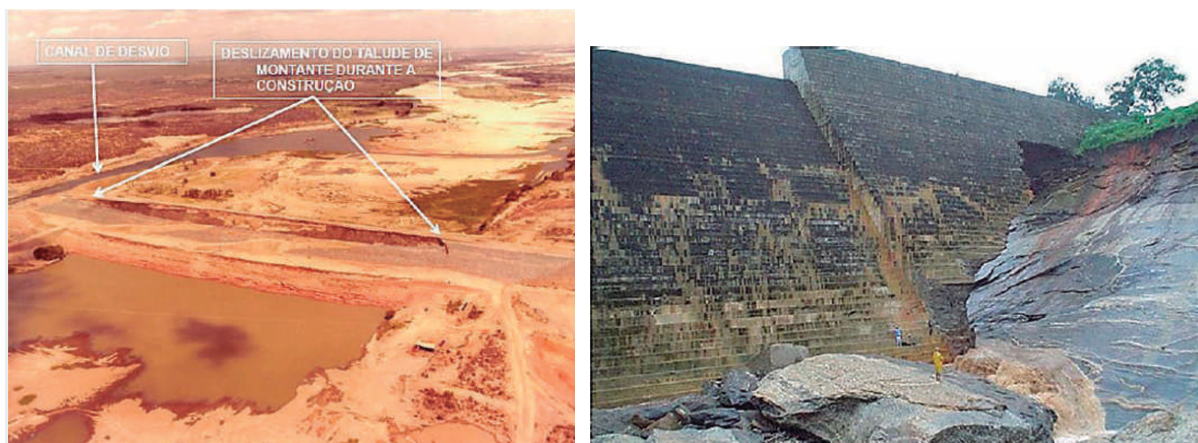
(a) deslizamento do talude de montante em barragem de aterro durante a fase de construção; (b) brecha decorrente de colapso estrutural em barragem de concreto gravidade.
