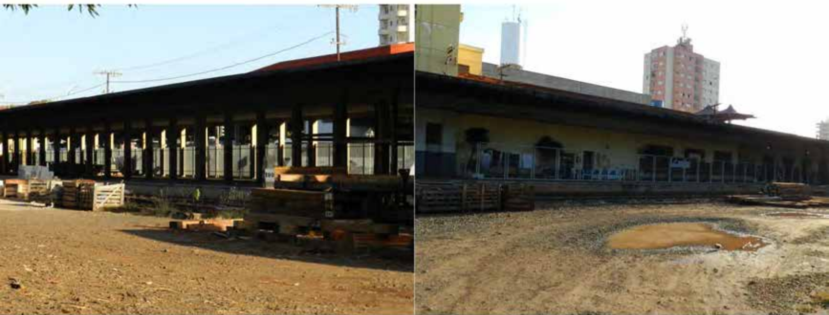
Figuras 53 e 54: A Estação hoje funciona como um depósito da ferrovia. Encontra-se em péssimo estado de conservação no lado voltado à linha férrea.
