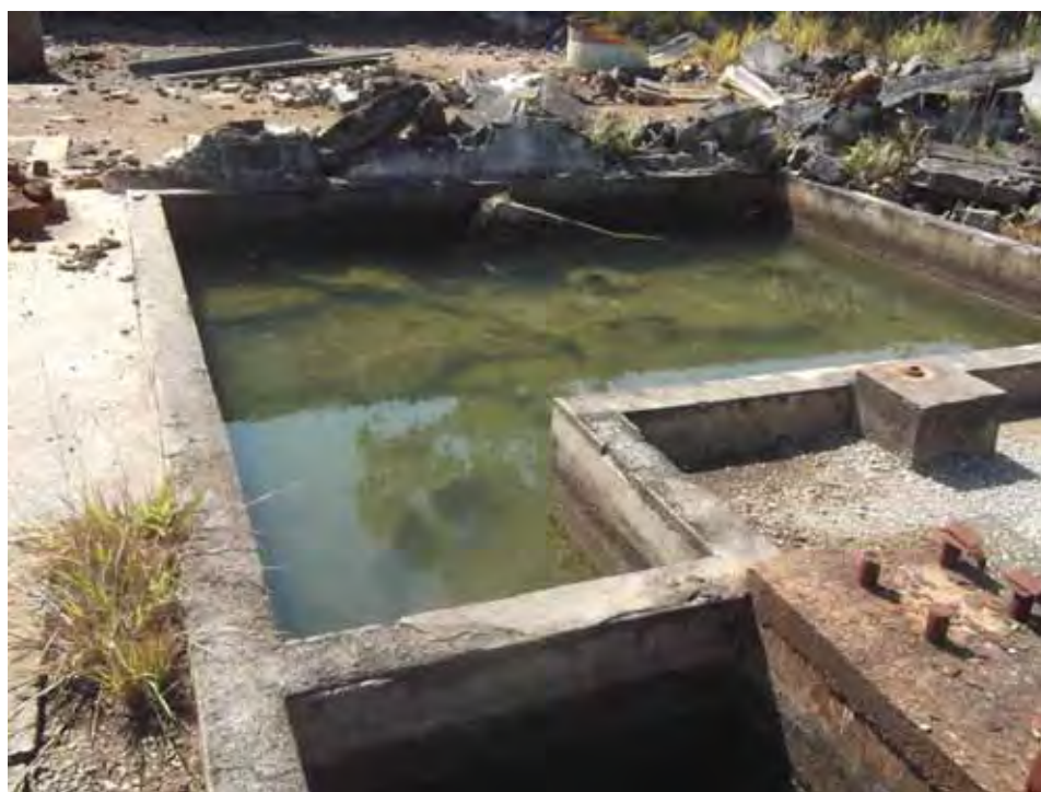
Foto 8: Tanques cheio de água parada.
