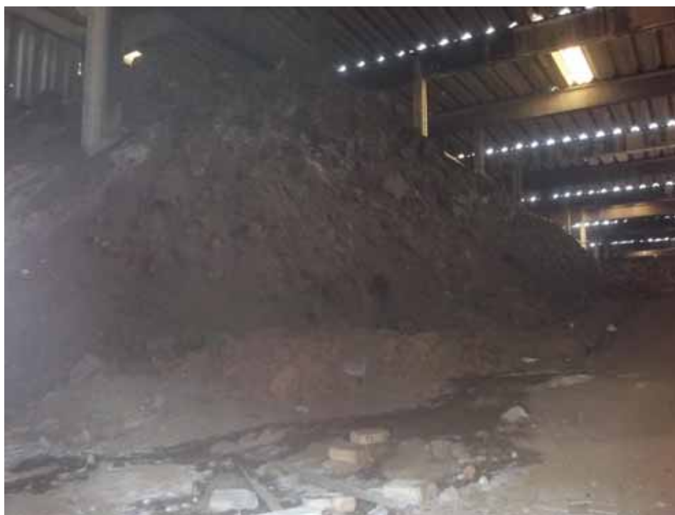
Foto 4: Escória de chumbo e entulho no interior da fabrica.
