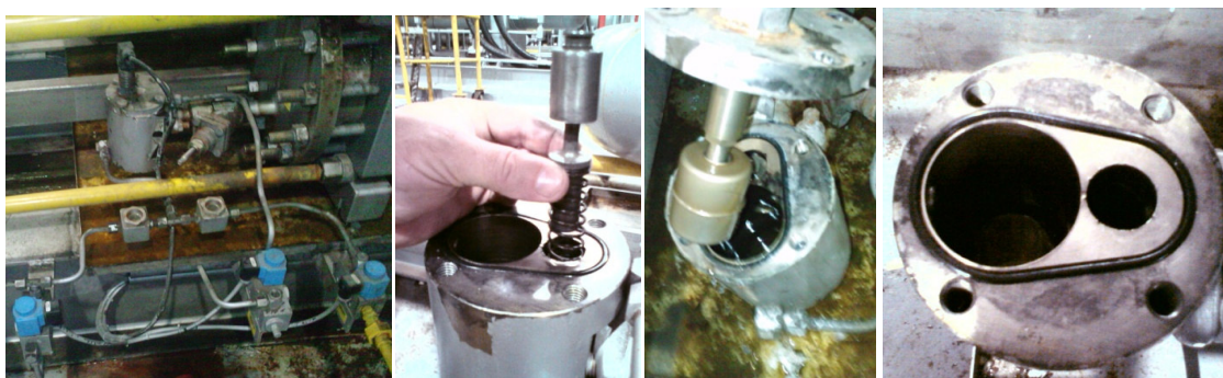
Figura 30 - Sistema de retorno automático de óleo em chillers , através de boia
