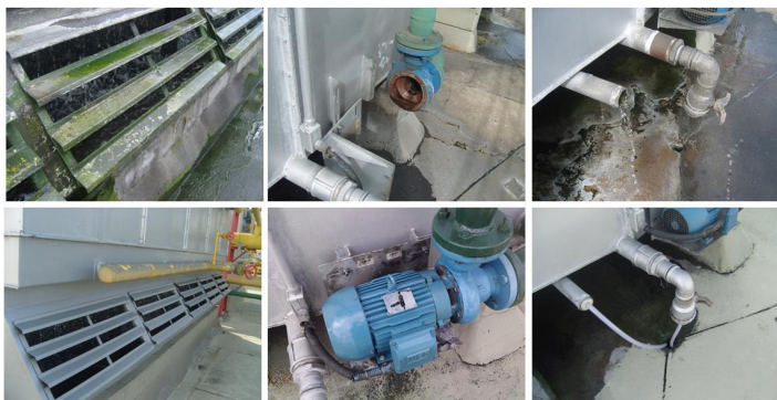
Figura 46 - Melhorias em condensadores evaporativos
