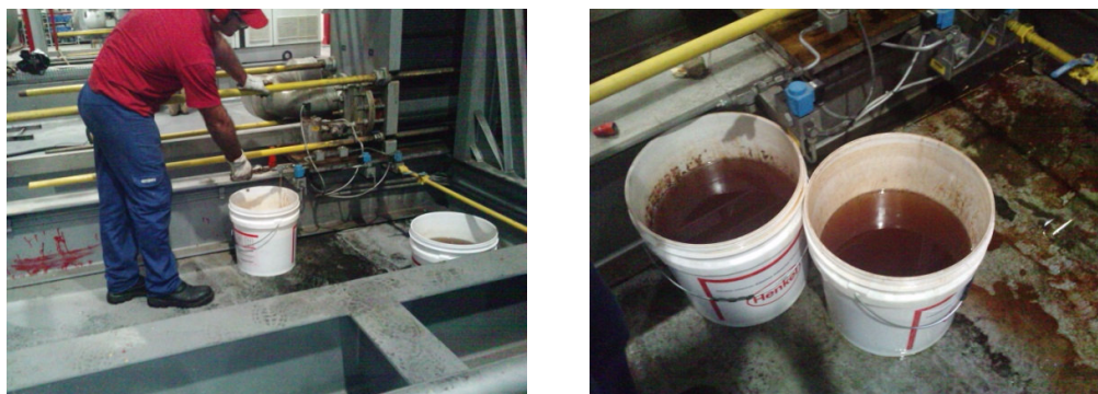
Figura 31 - Drenagem de óleo acumulado nos evaporadores
