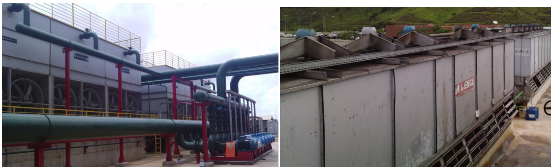
Figura 14 - Torres de resfriamento e condensadores evaporativos com ventiladores axiais
