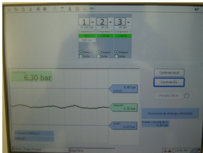
Figura 79 - Gerenciador dos compressores de ar
