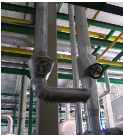
Figura 42 - Tubulações do compressor coringa
