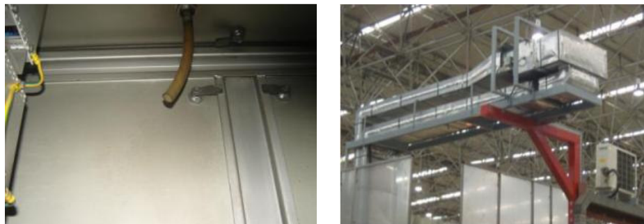
Figura 68 - Refrigeração de painéis, antes com ar comprimido e depois com ar condicionado
