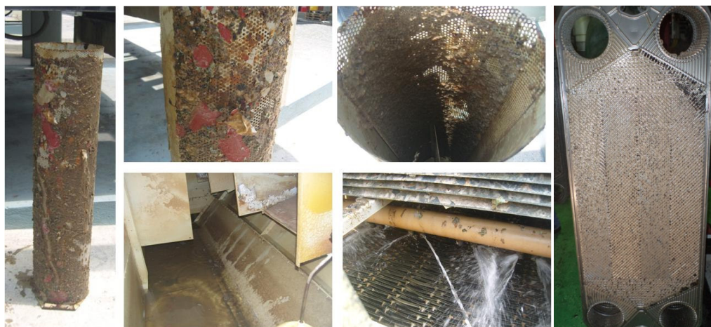
Figura 33 - Entupimento dos filtros e dos bicos das torres de resfriamento, e incrustação do trocador de calor
