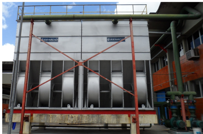
Figura 15 - Torre de resfriamento com ventiladores centrífugos
