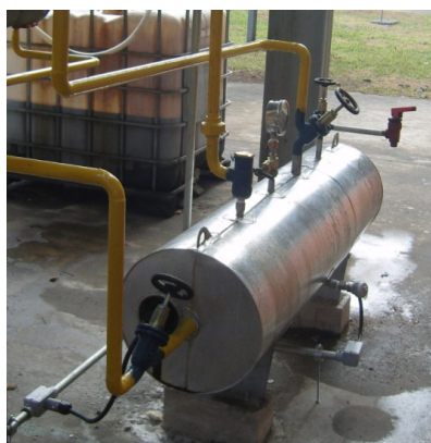
Figura 28 - Potes de coleta de óleo e água com resistor elétrico
