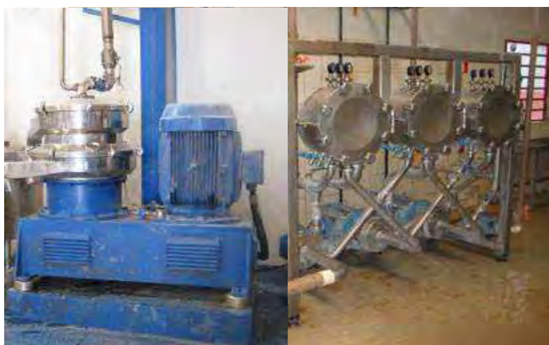
Figura 11. Centrífuga e hidrociclones
