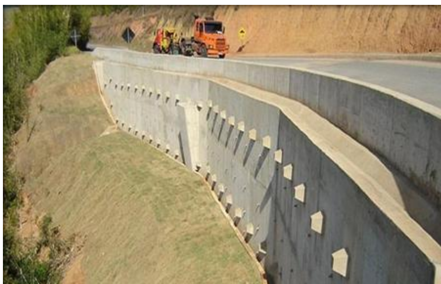
Figura 11 - Cortina atirantada contendo encosta em estrada
