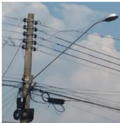
Figura 6 – Braços de sustentação para iluminação pública
