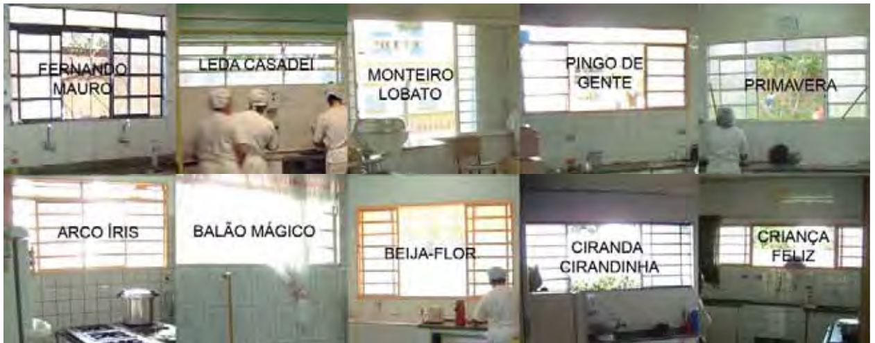
Figura 10 Imagens de janelas de algumas EMEIs sem a proteção devida
